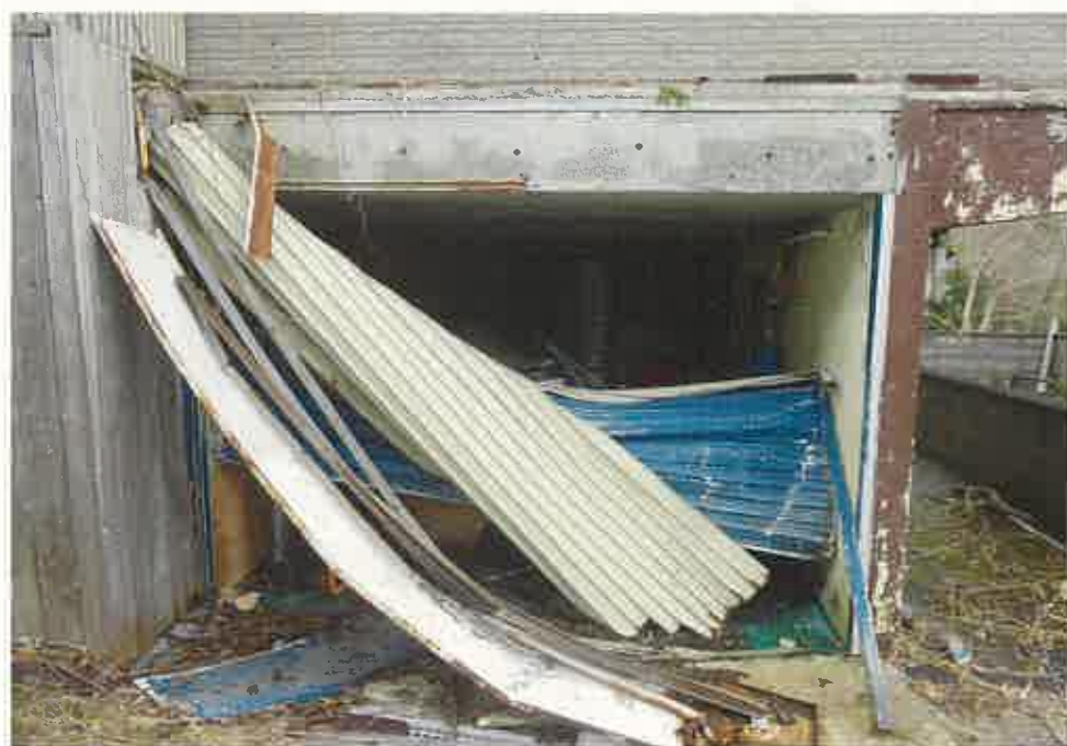
車庫 シャッターの状況
