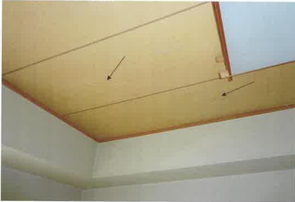
和室 天井の雨漏り跡
