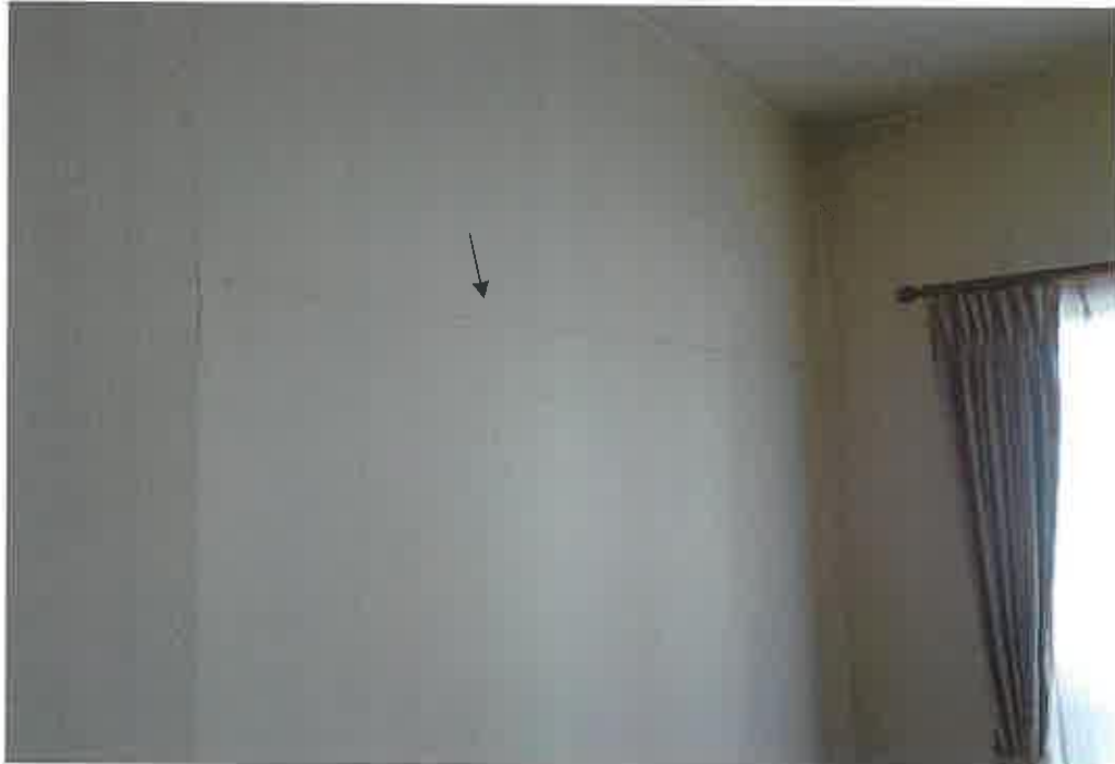
食堂 内壁の亀裂
