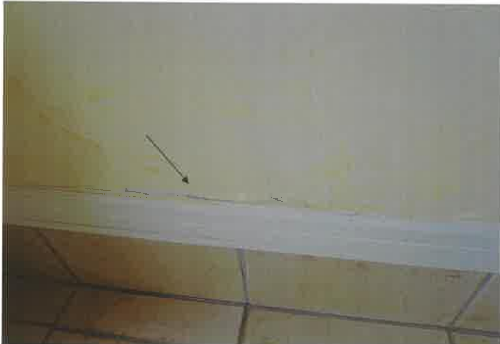
玄関内 壁紙の剥がれ
