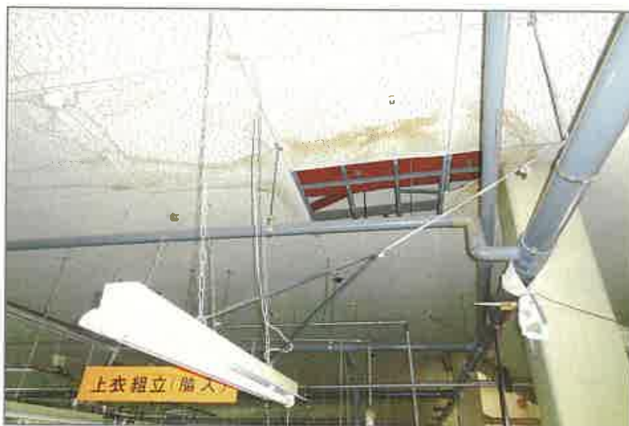
②③物件4(天井の損傷状況)(2階作業場)
