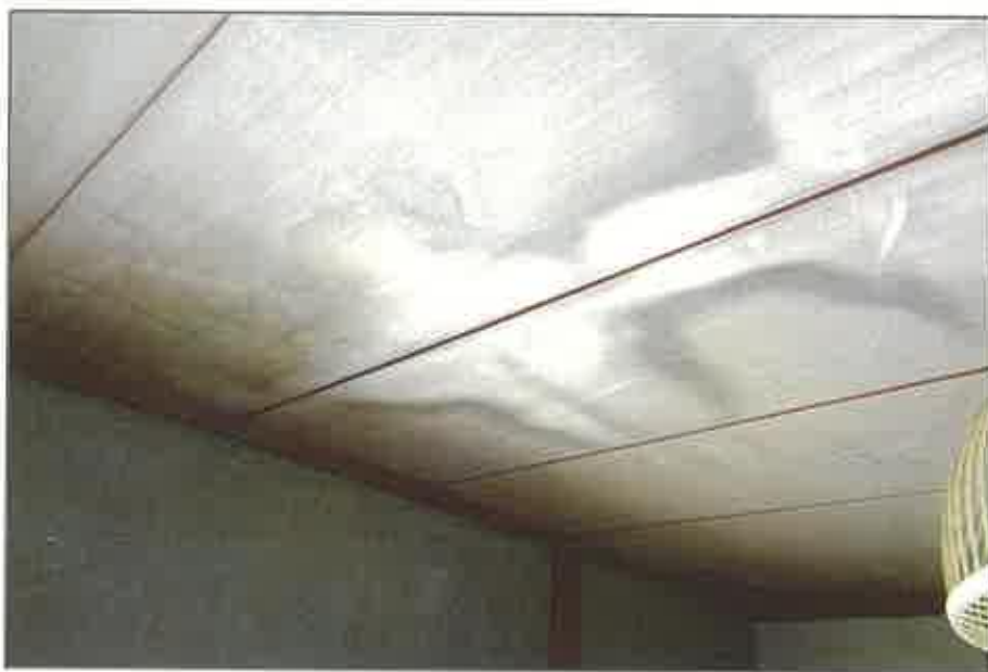
③③物件5の天井の状況
