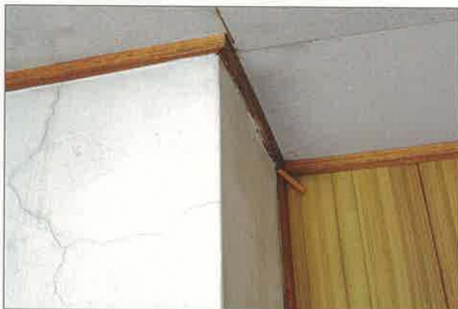
③②物件5(煙突付近の壁の状況)
