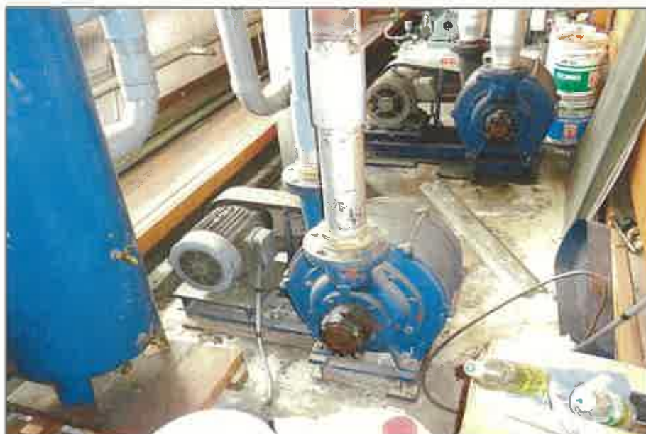
⑯物件4(1階機械室)
