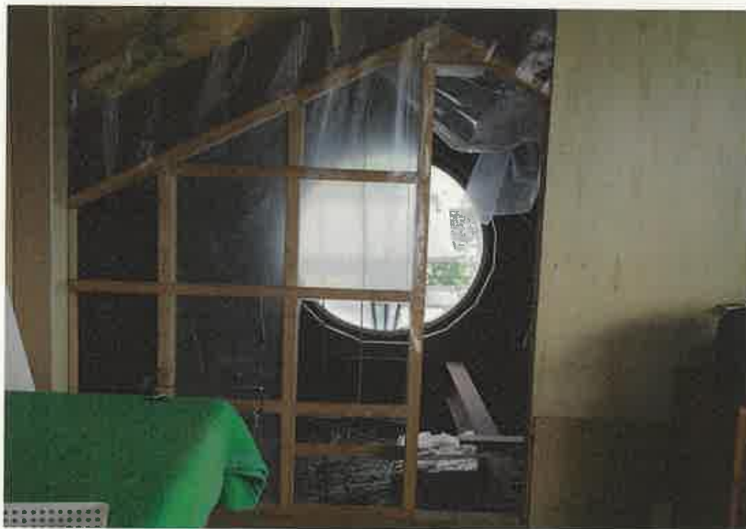
14 3階物置壁（損壊状況）
