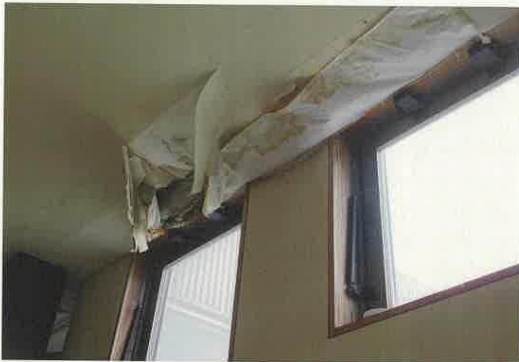
11 2階ホール天井（損壊状況）
