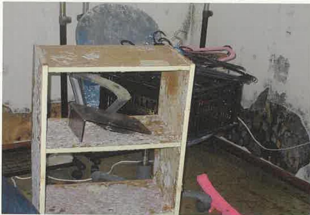
21 地下1階物置2②（汚損状況）
