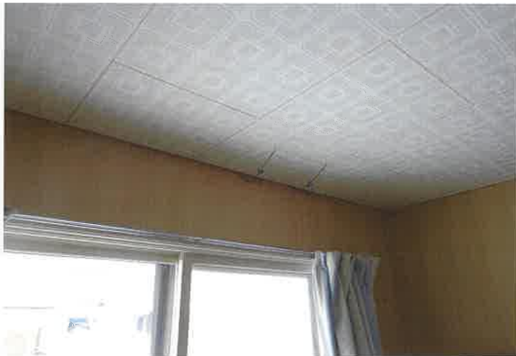
洋室2 天井付近の雨染み
