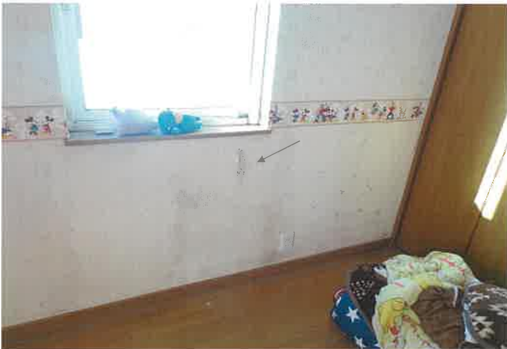
洋室③ 壁紙の剥がれ
