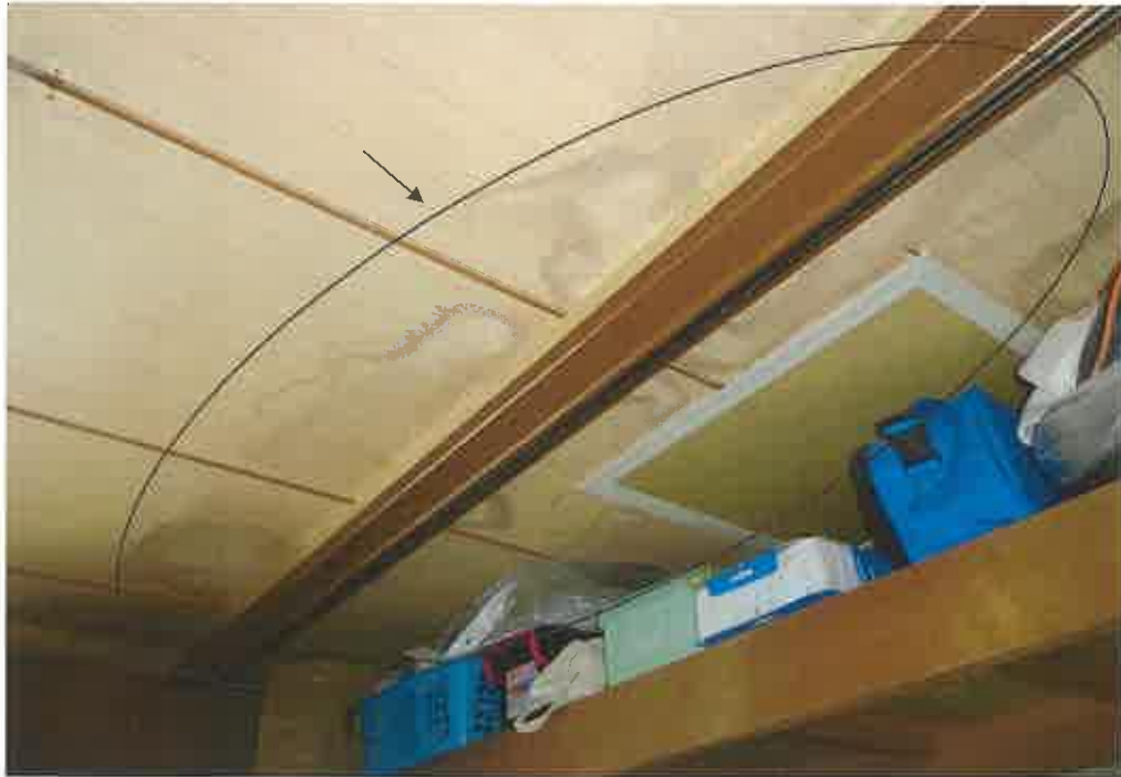
洋室1 天井の雨漏り跡
