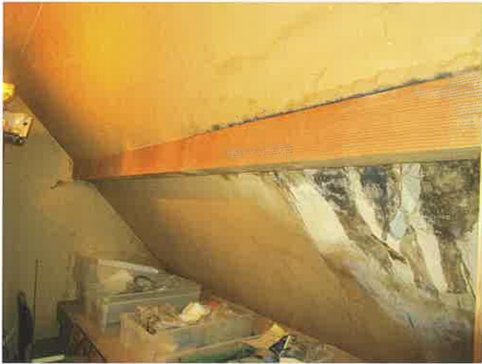
物置1の雨漏り痕
