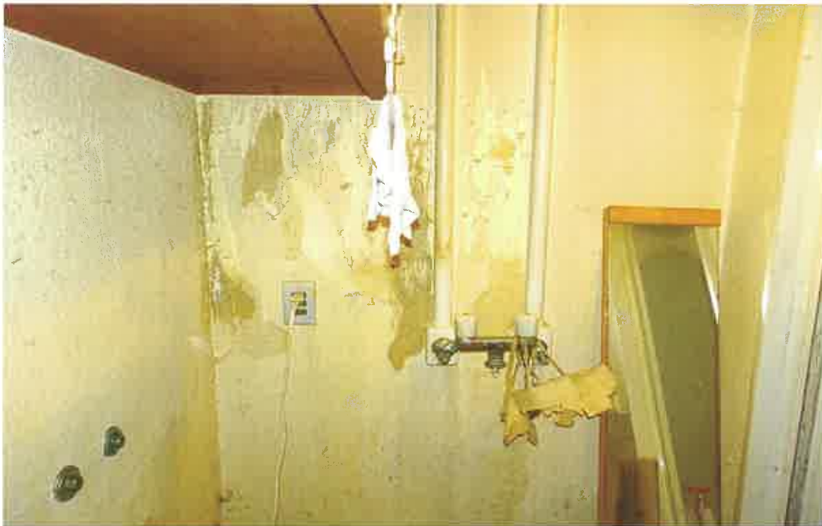
9 浴室付近の内壁の汚損状況等（402号室）
