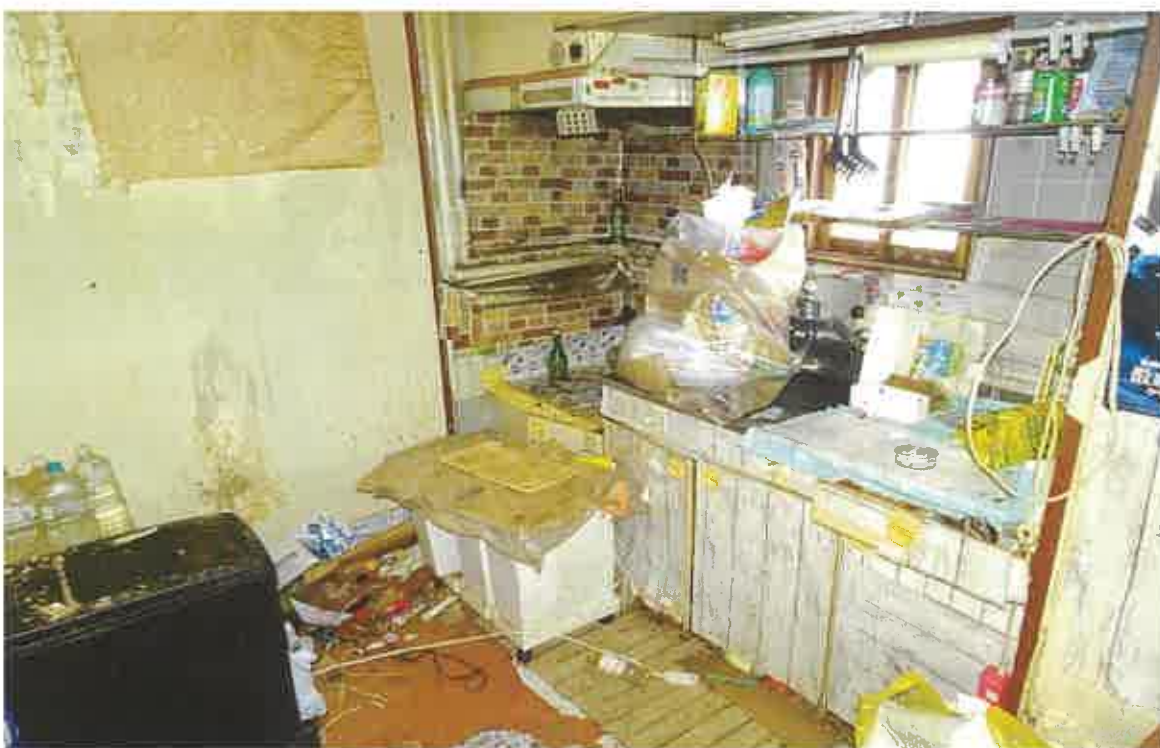
10 台所の汚損等の状況（402号室）
