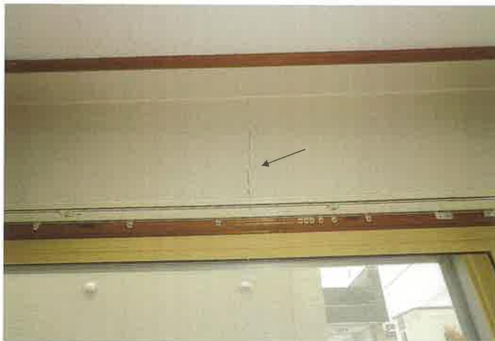
101号室 居間の壁紙の剥がれ
