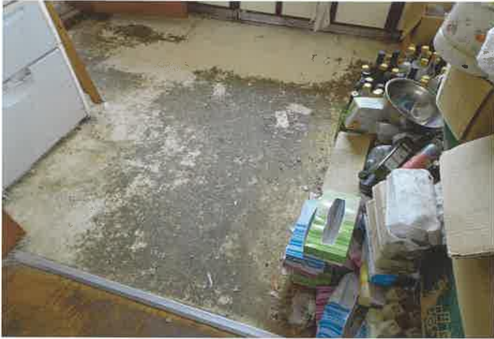
202号室 台所の床の汚損
