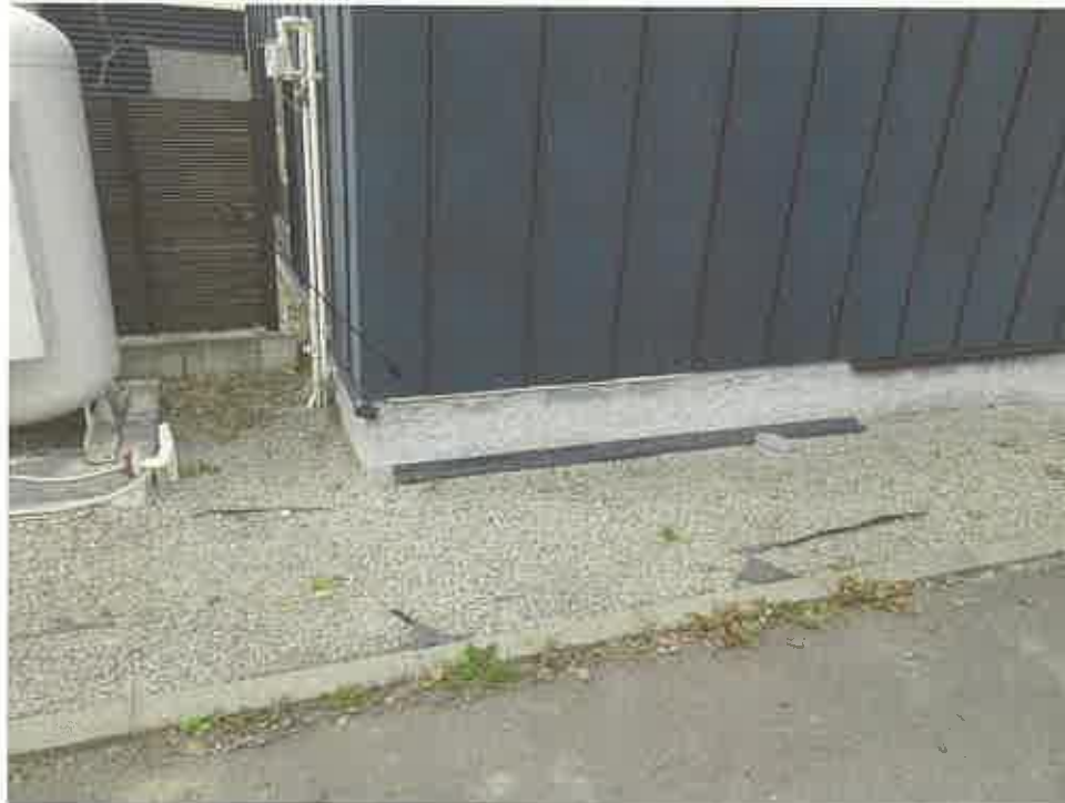
6 外壁下部水仕切り（損壊状況②）
