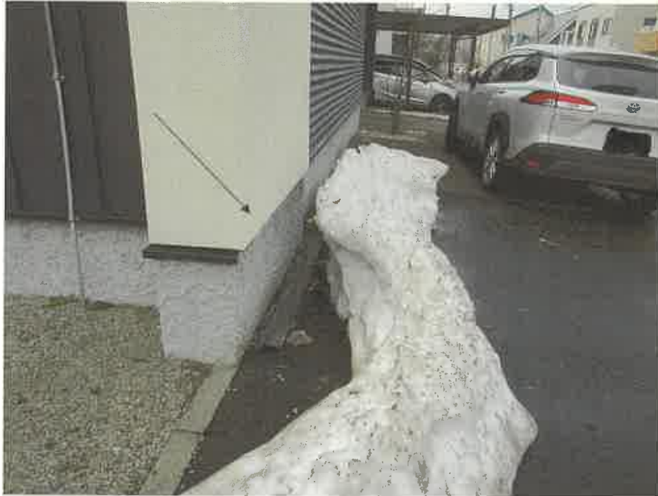
5 外壁下部水仕切り（損壊状況①）
