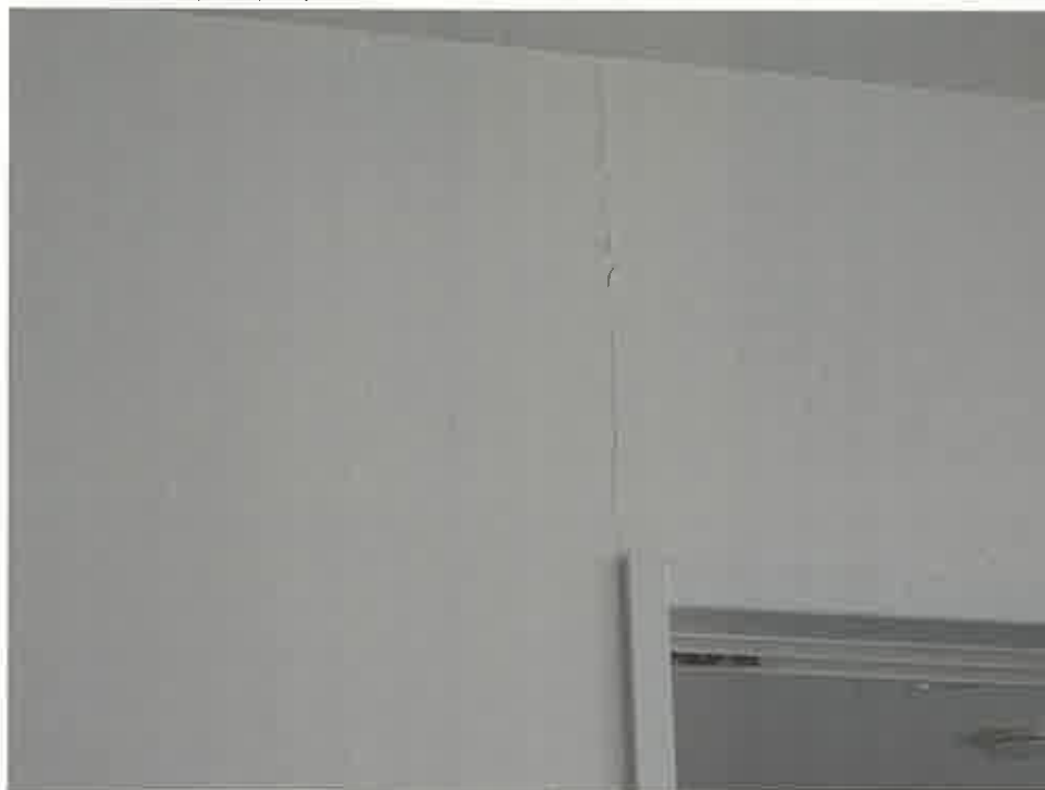
6 1階居間の壁（亀裂状況）
