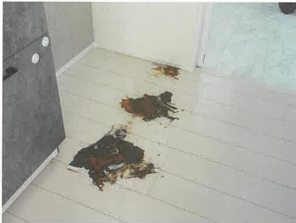
5 1階キッチン冷蔵庫スペース付近の床（汚損状況）
