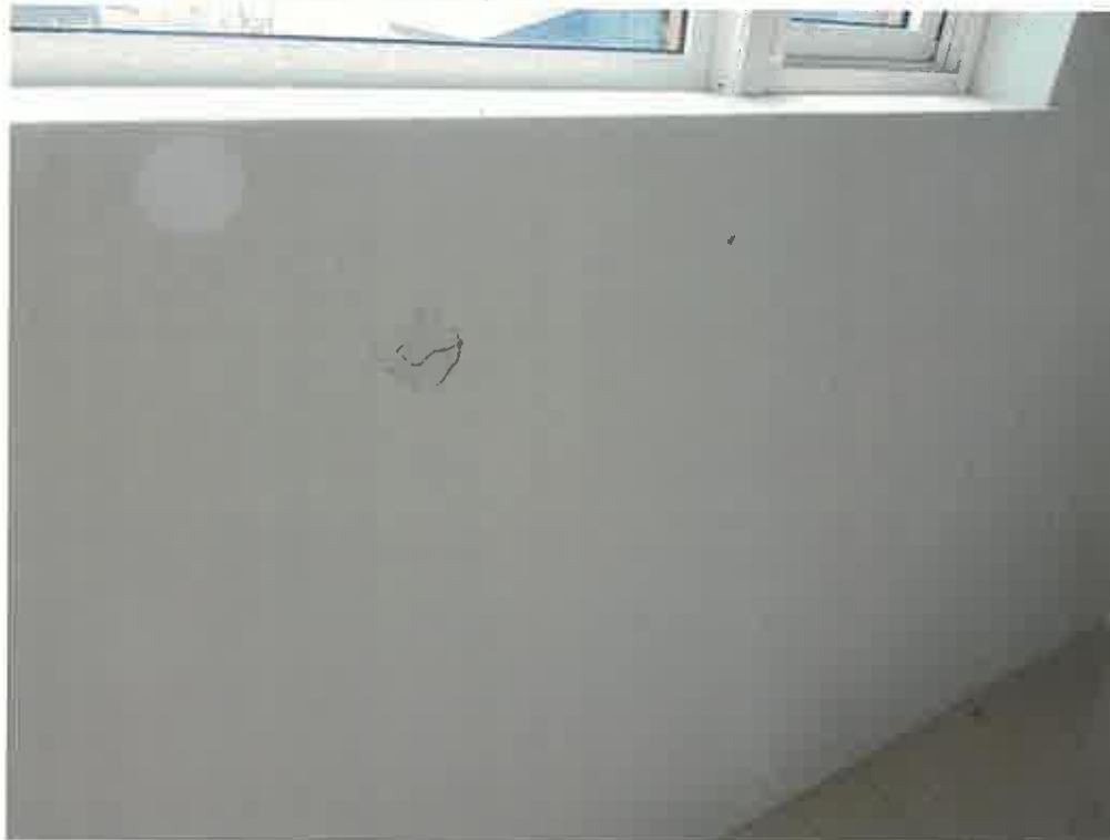
10 2階洋室3の壁（拳大の穴、損壊状況）
