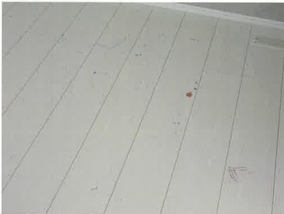
6 1階居間の床（汚損状況）
