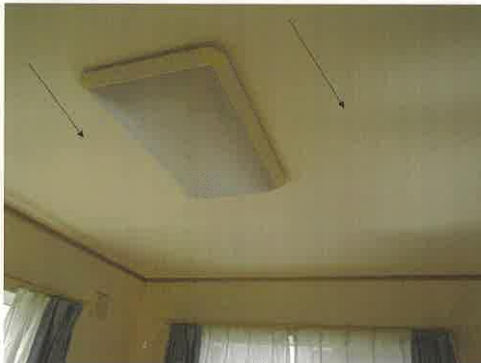
10 2階洋室2天井（亀裂状況）
