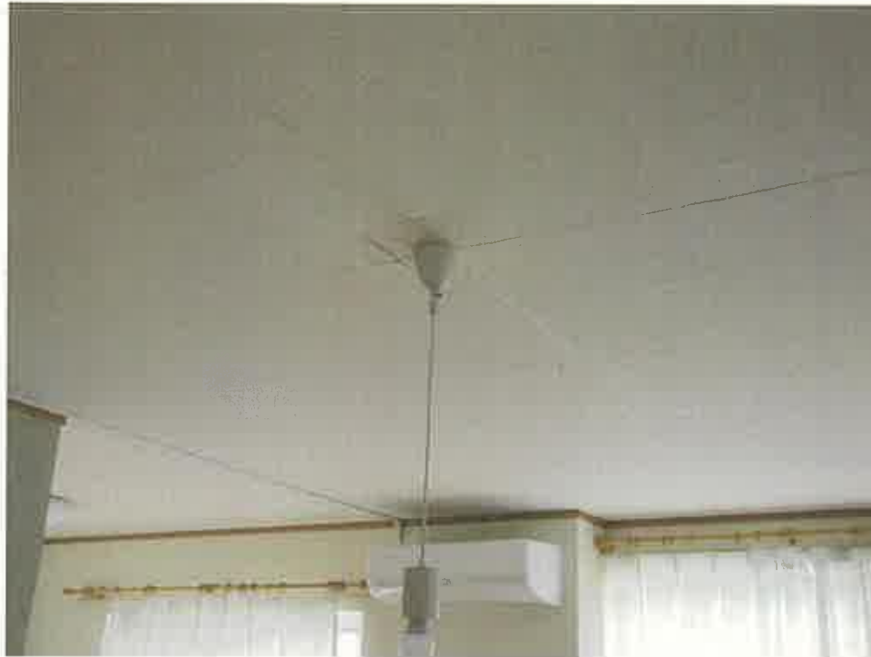
9 1階居間天井（亀裂状況）
