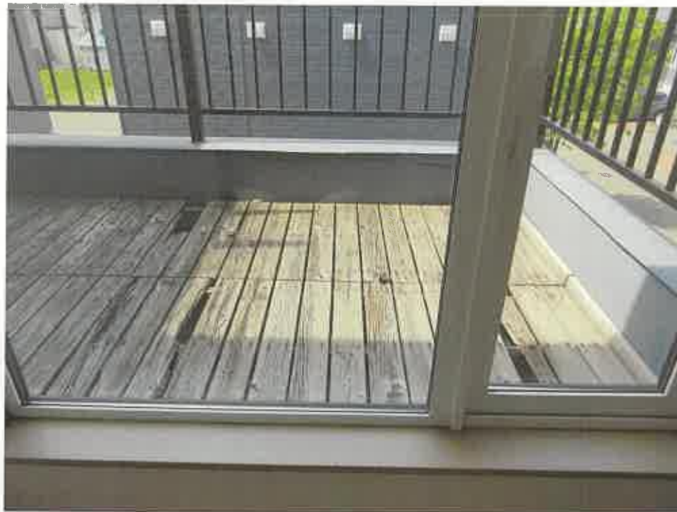
13 2階バルコニー敷設のすのこ状木製板（損壊状況）
