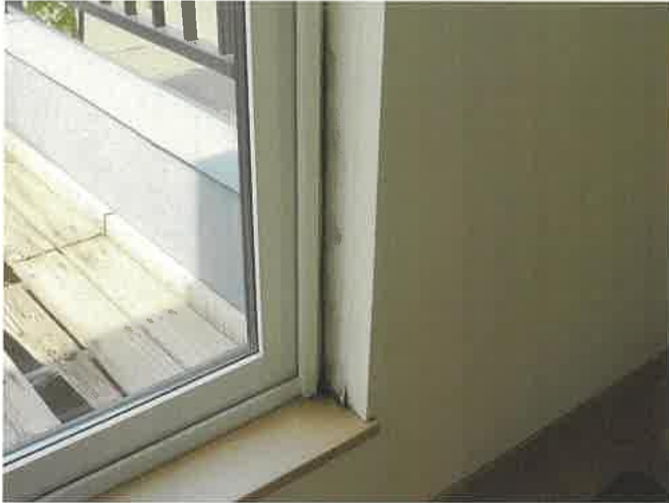
11 2階洋室1窓枠付近の壁紙（汚損状況①）
