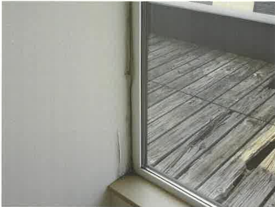
12 2階洋室1窓枠付近の壁紙（汚損状況②）
