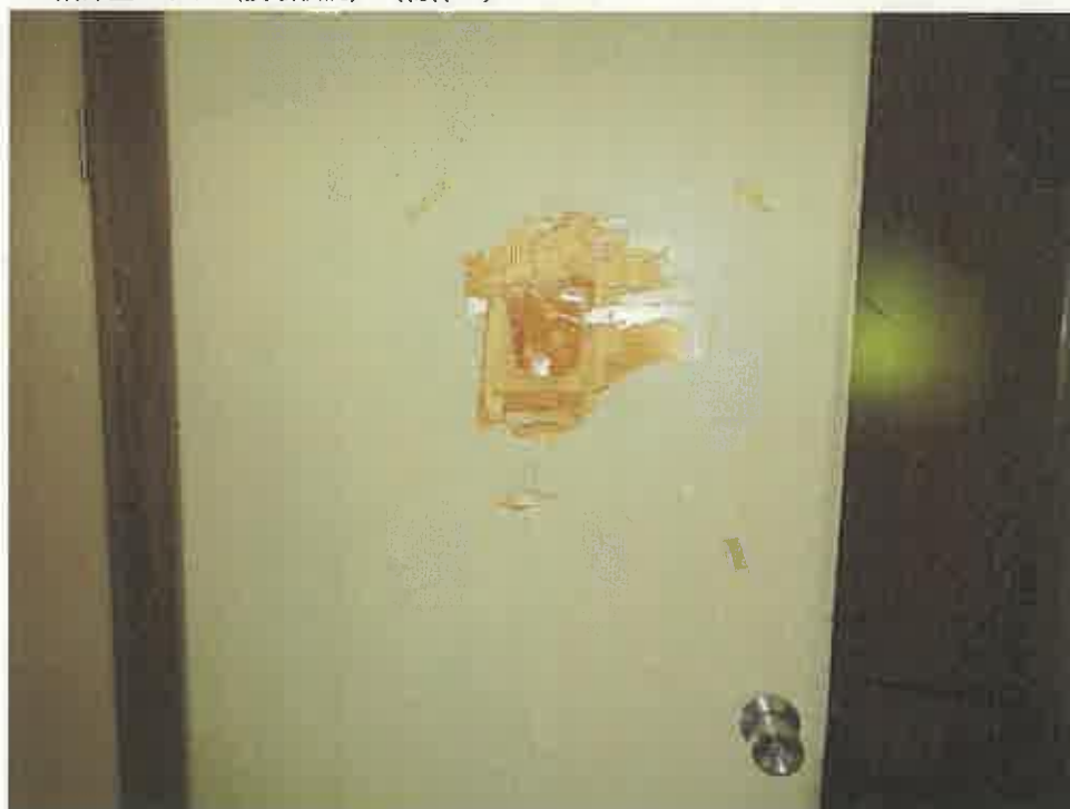
8 2階洋室3ドア（損壊状況）（物件4）
