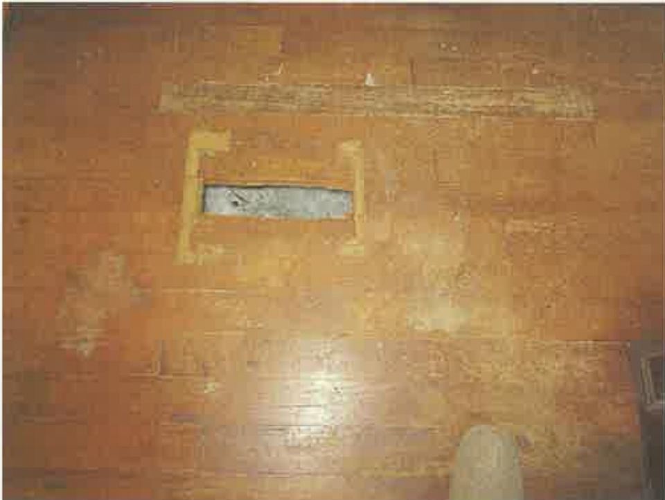
6 2階廊下床板（損壊状況）（物件4）
