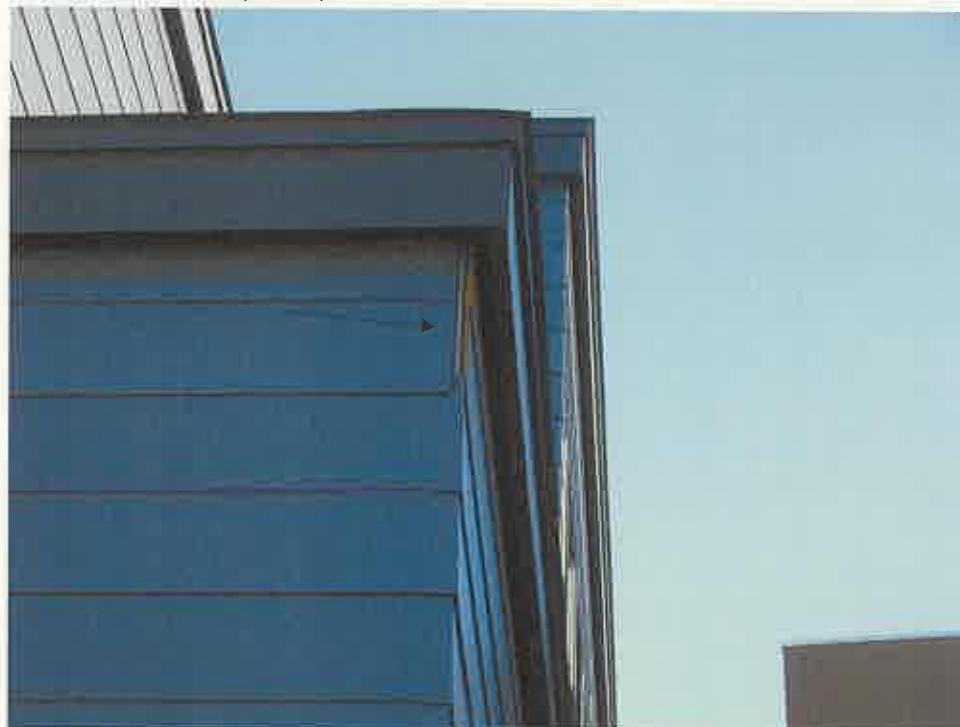
14 外壁（剥離状況）（物件5）
