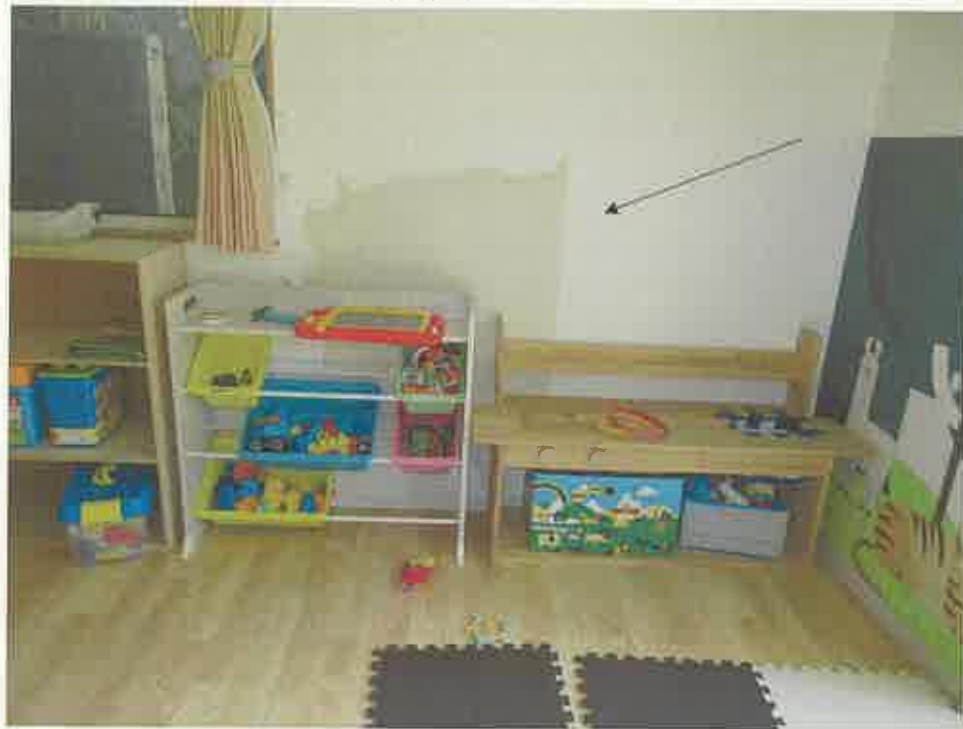
15 1階ほふく室壁紙（剥離状況）（物件5）
