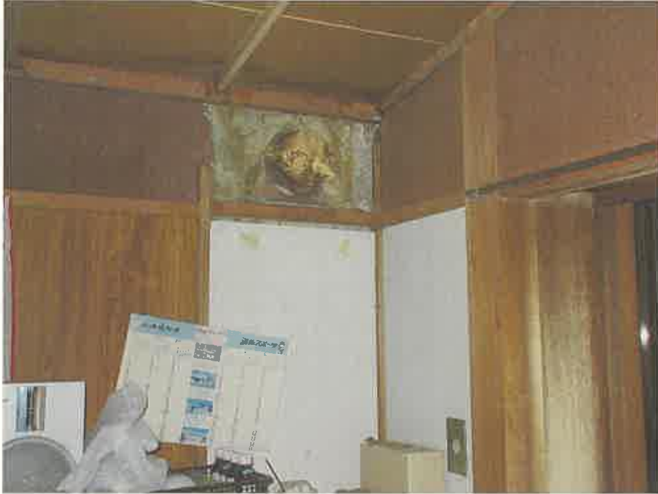
5 1階壁板（剝離状況）（物件4）
