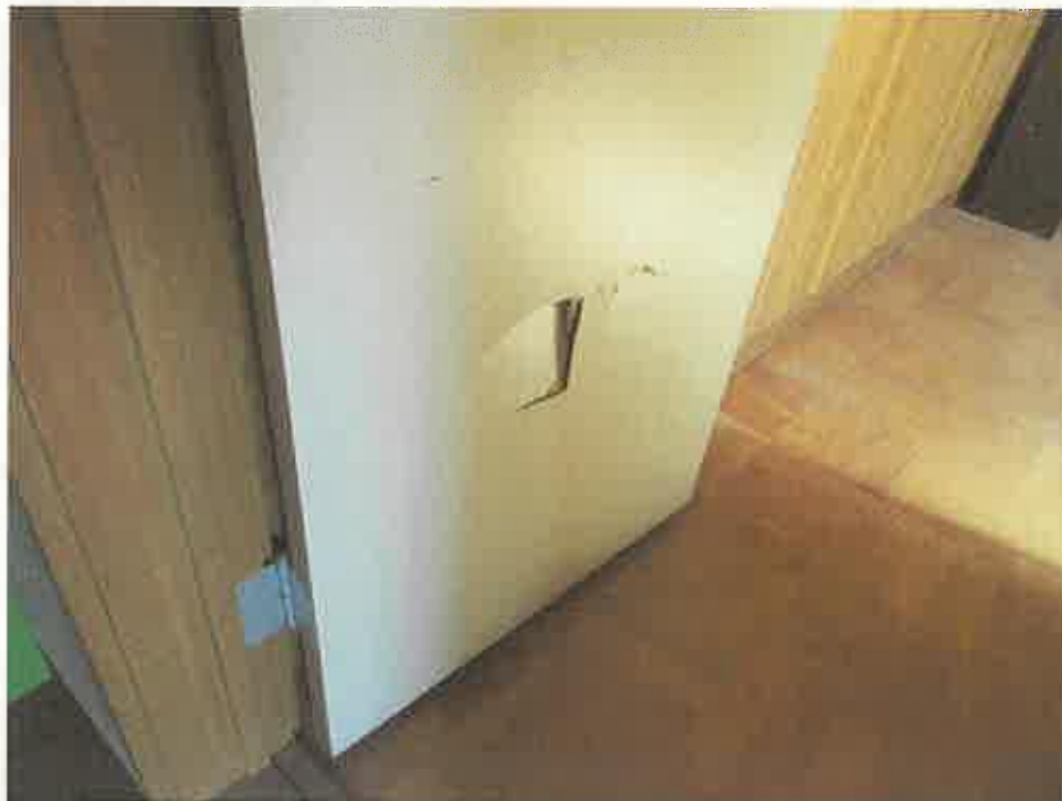
7 2階洋室2ドア（損壊状況）（物件4）
