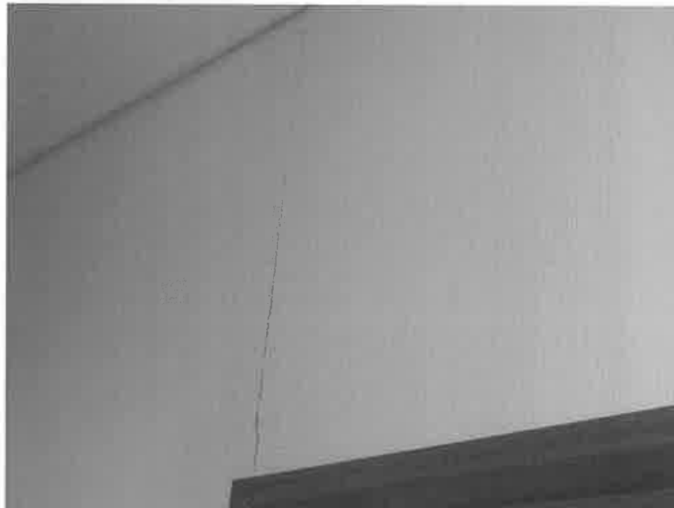
8 2階階段共用部分壁（亀裂状況）
