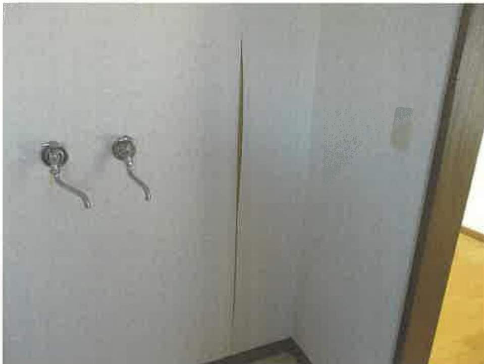
10 脱衣所壁紙（剥離状況）
