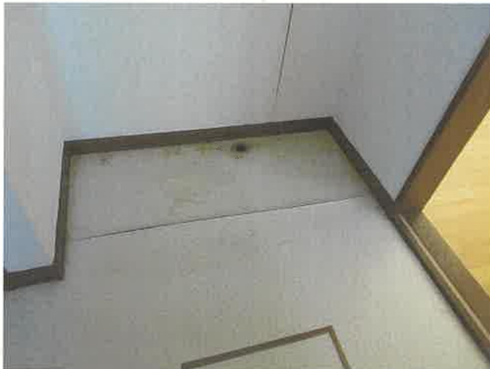
9 脱衣所床材（剥離状況）
