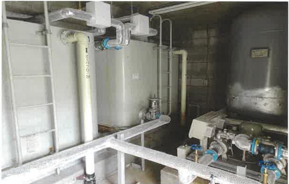
6 ポンプ室内部（物件4）
