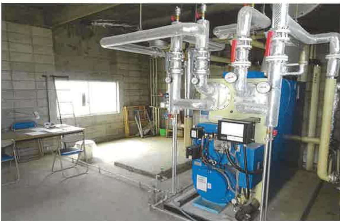
8 ボイラー室内部（物件5）
