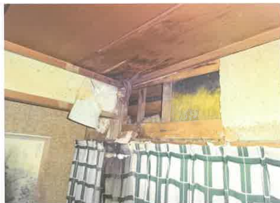
2 階和室窓側の壁付近の損傷状況
