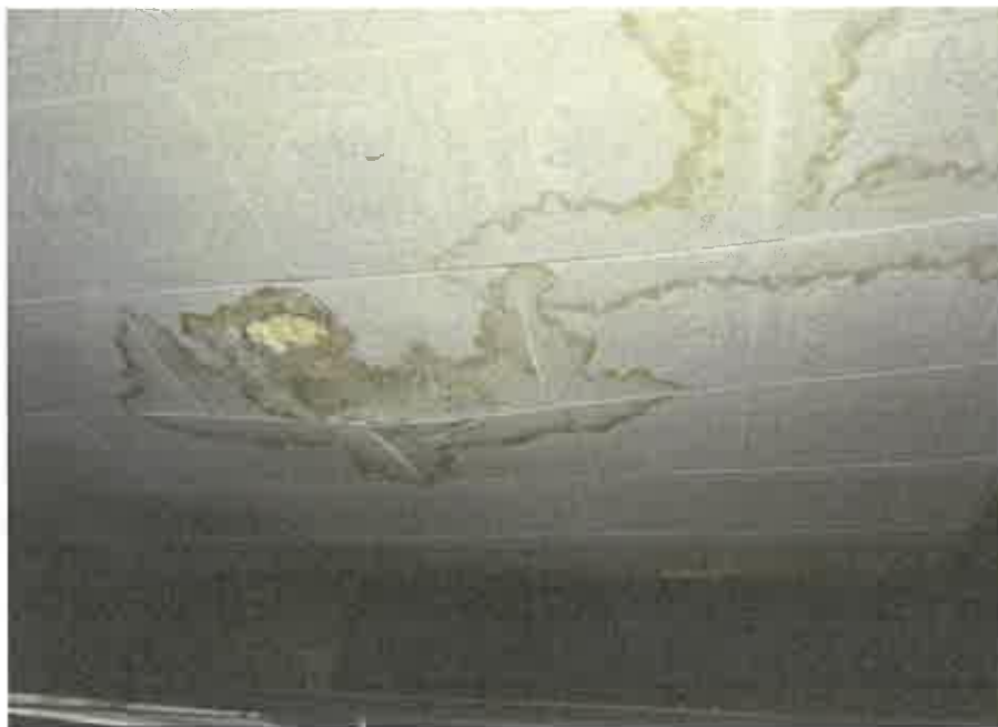
2 階居間の天井クロスのかぶれ及び染みの状況
