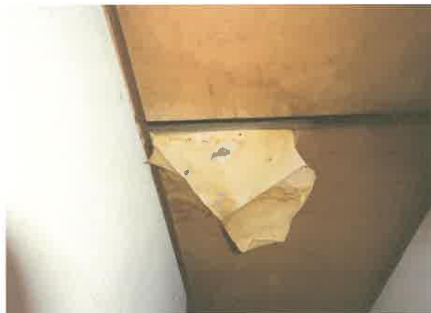
2 階廊下の天井クロスの剥離状況
