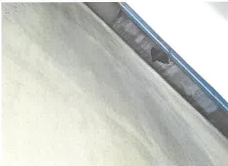
軒天の損傷状況
