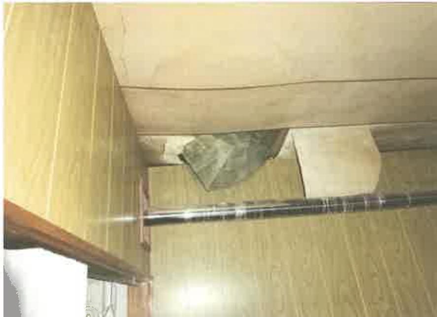
2 階洋室 3 の天井の崩落状況
