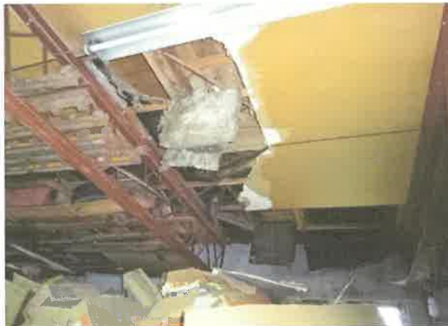
1 階倉庫の天井の損傷状況
