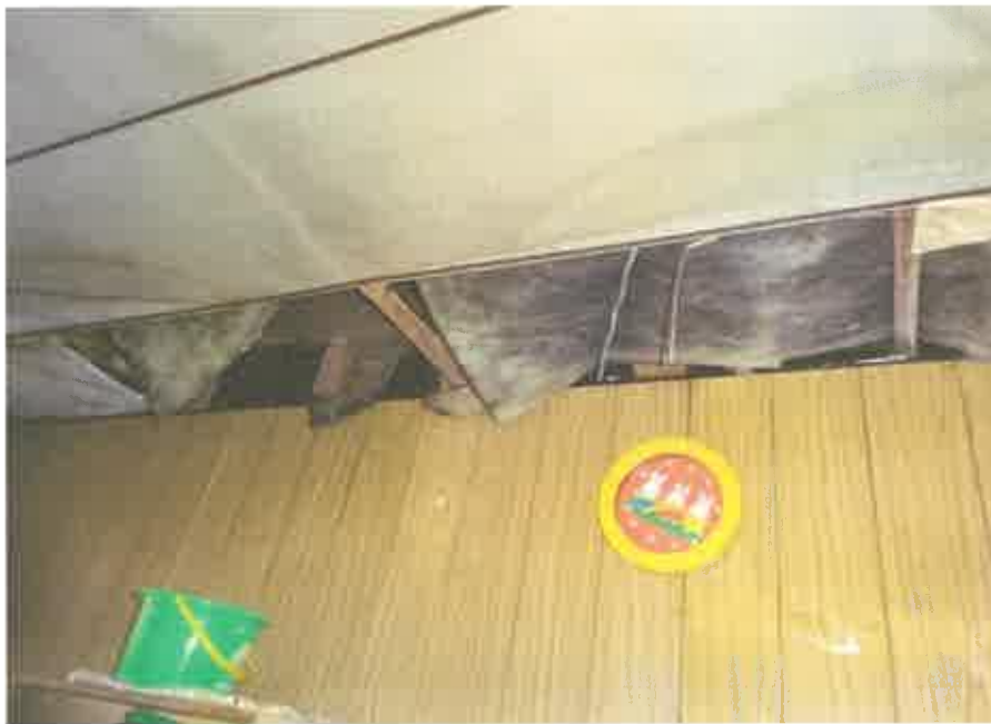
2 階洋室 2 の天井の崩落状況
