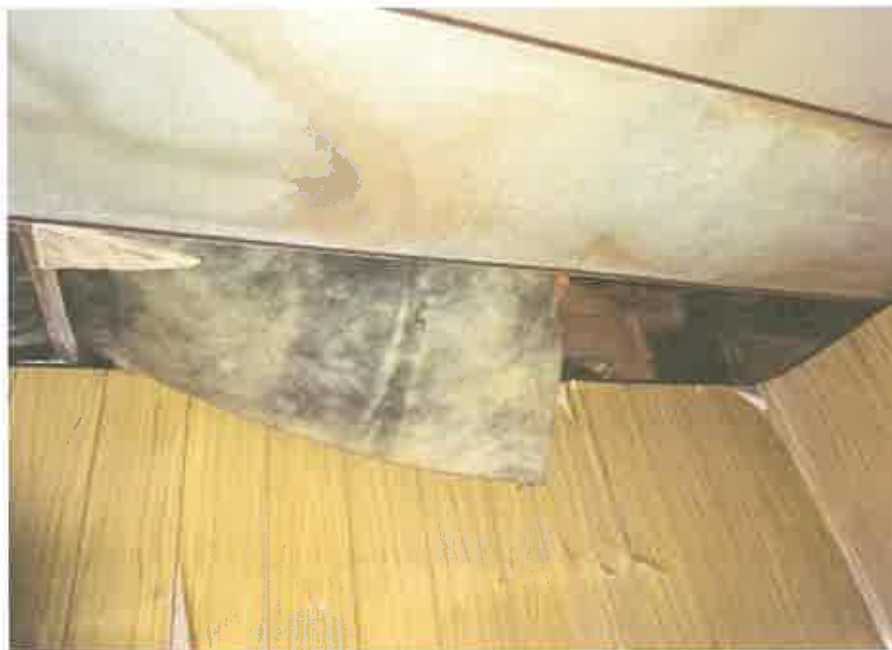
2 階洋室 2 の天井の崩落状況
