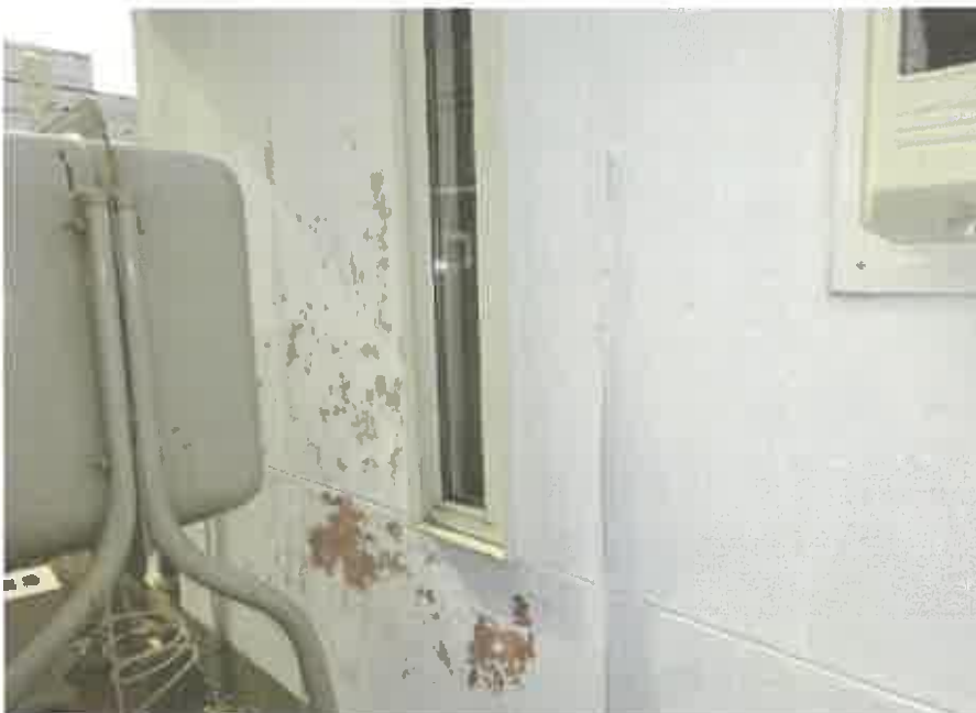
外壁塗膜の剥離の状況
