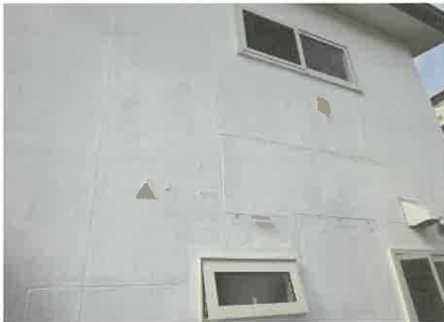
外壁塗膜の剥離の状況
