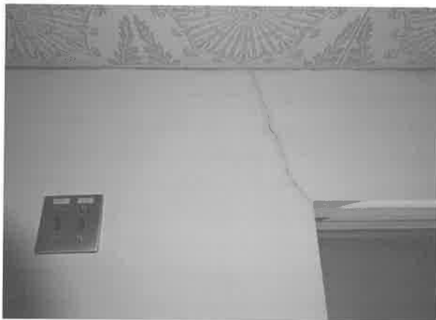
壁の亀裂の状況
