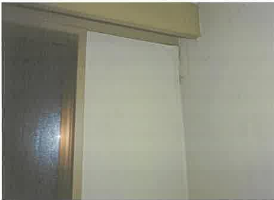
壁紙の剥離状況
