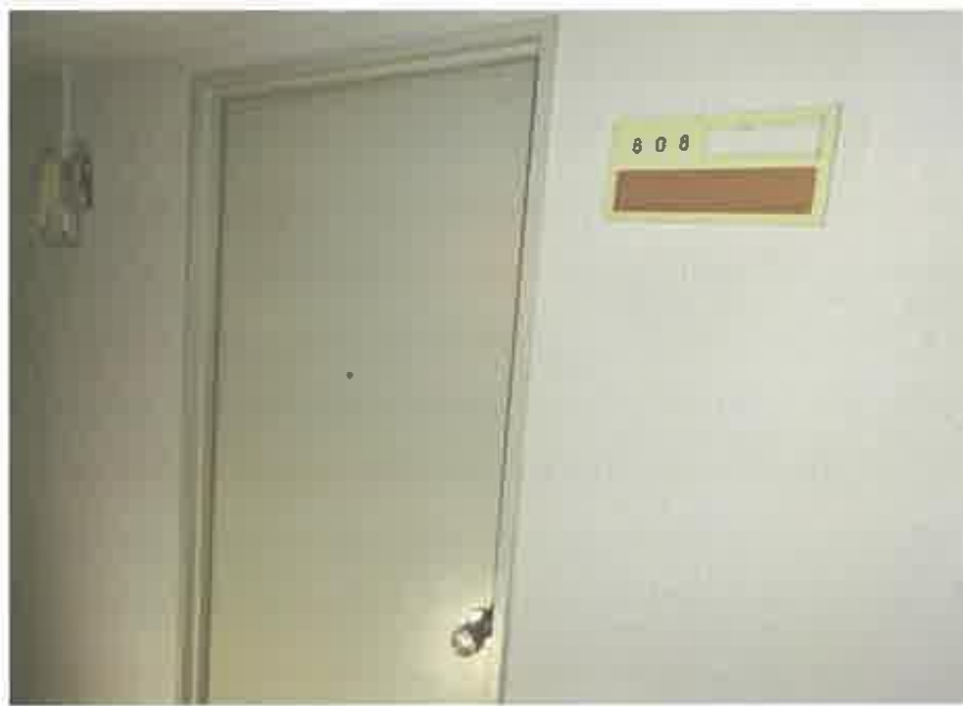
本件建物の入口付近の状況
