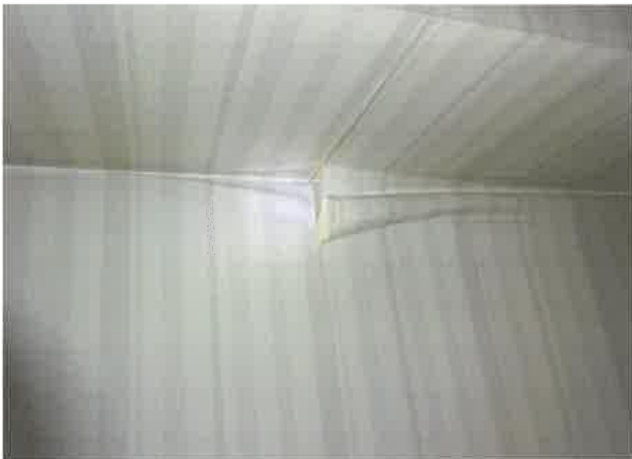
壁紙の剥離状況
