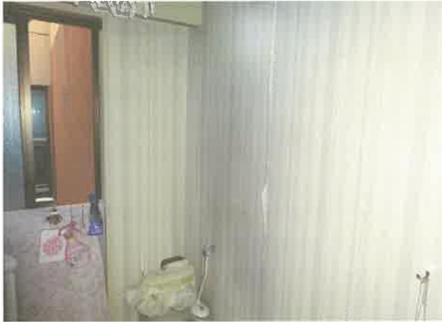
壁紙の剥離状況
