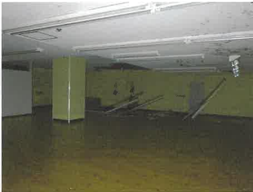
物件 5 の 5 階略南西側の元店舗部分
