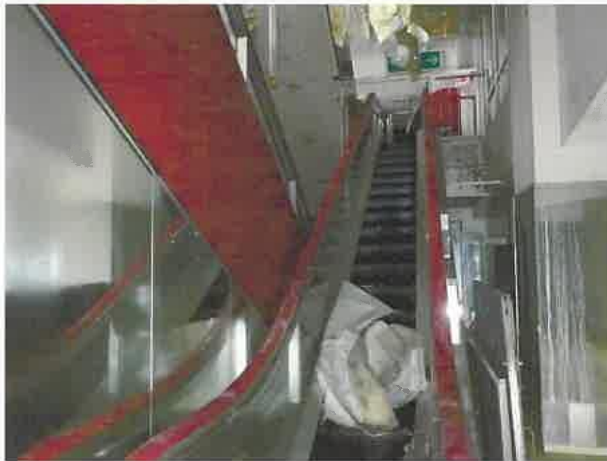
一棟の建物の地下1階略東側のエスカレーター
