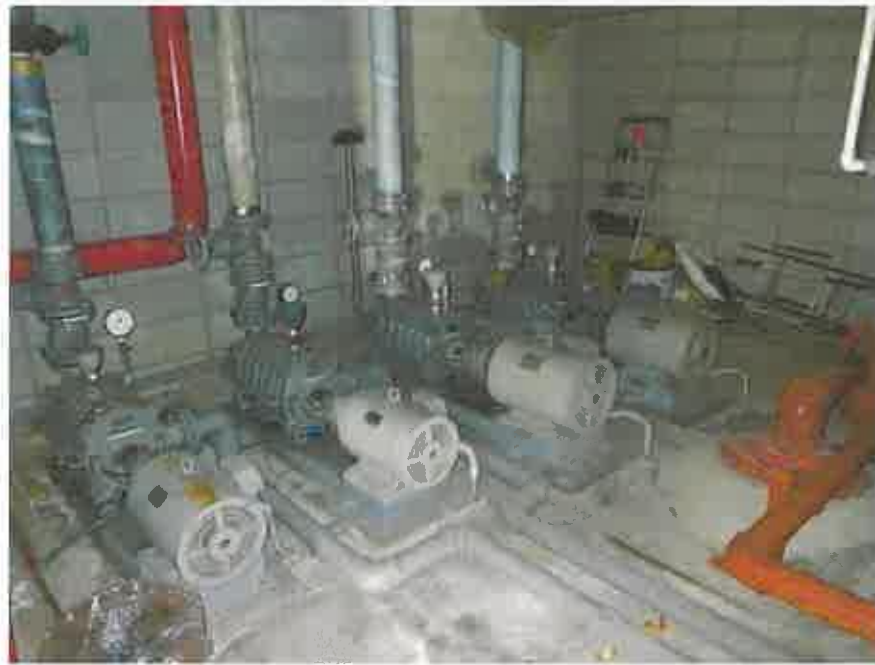
物件3の地下1階略西側の機械室（水道ポンプ）
