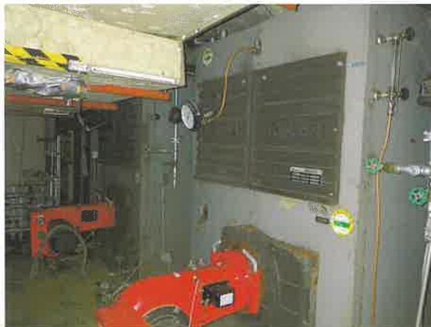
物件3の地下1階略西側のボイラー室
