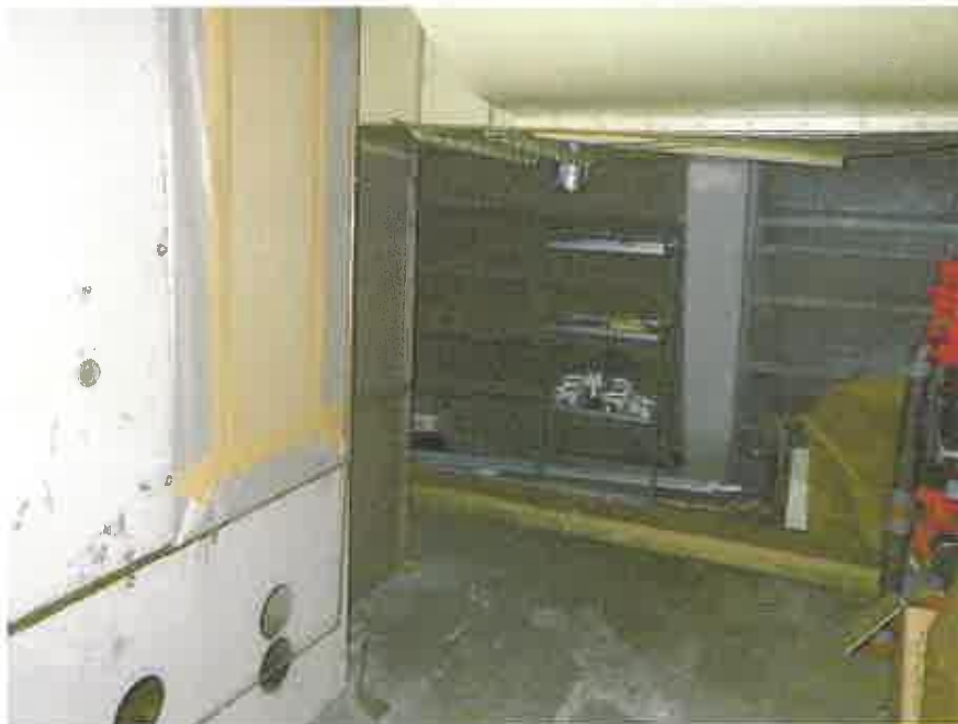
物件7の6階略南側の空調機械室
