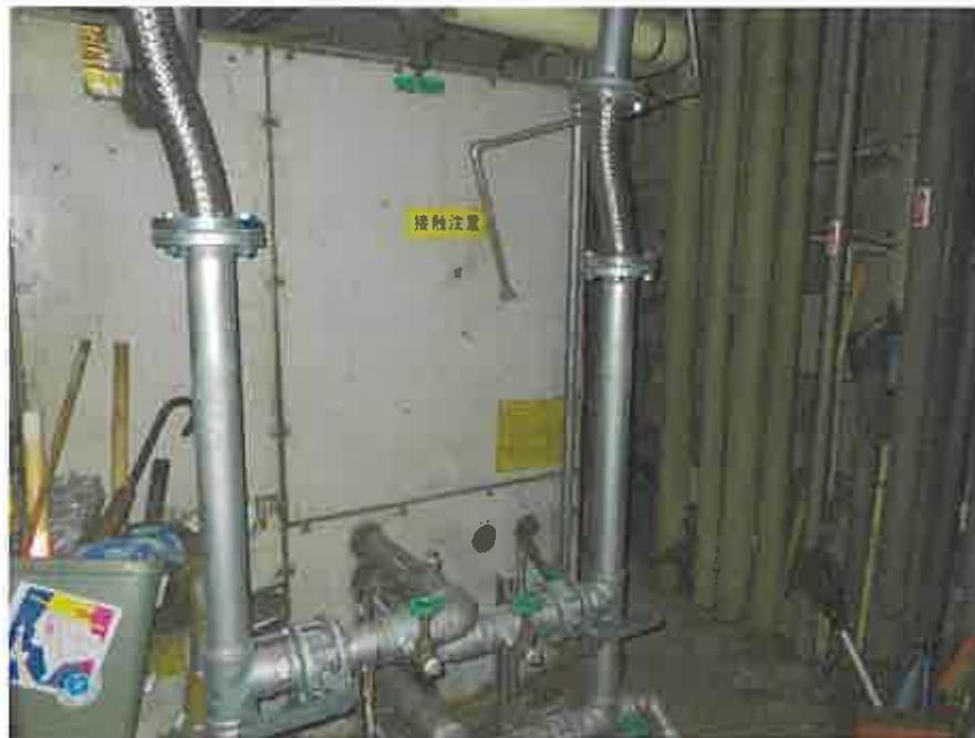
物件3の1階略北西側の機械室
