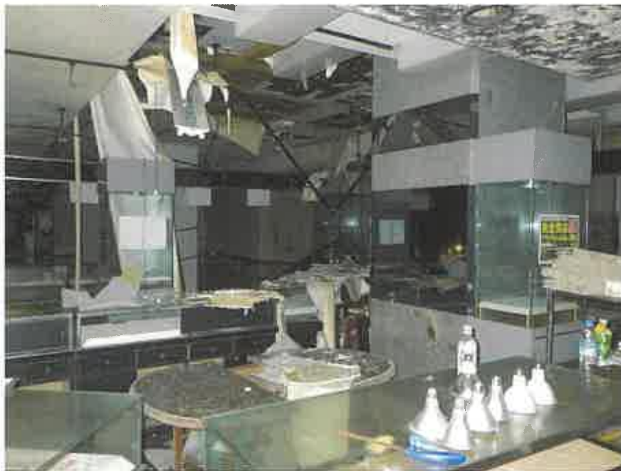
物件 3 の 1 階略南西側の元店舗部分
