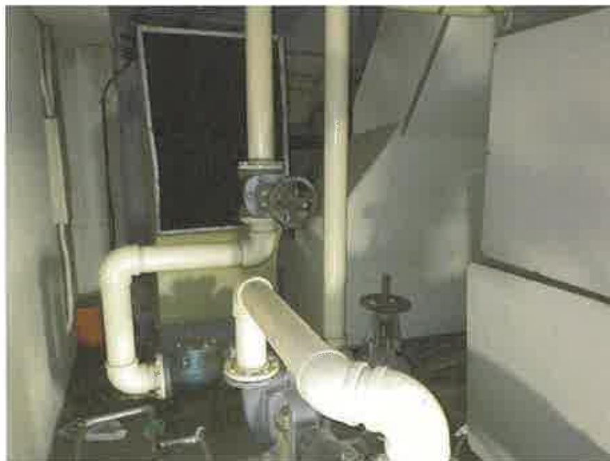
物件7の6階略西側の空調機械室
