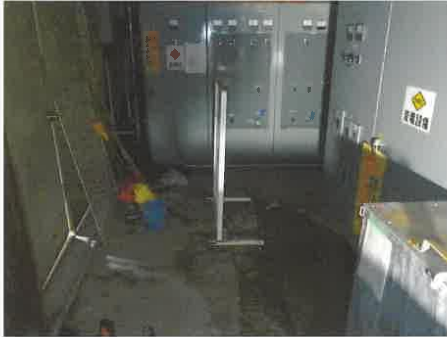
物件 7 の 6 階略南西側の電気室
