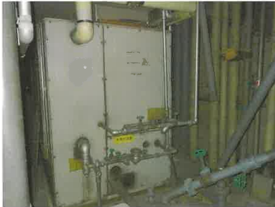
物件3の3階略北西側の空調機械室
