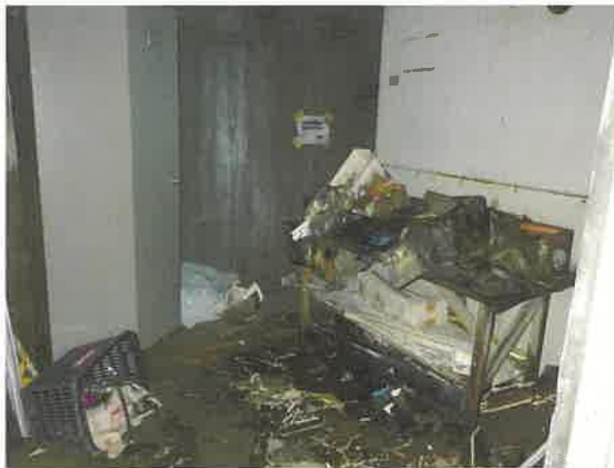
物件3の2階略西側の空調機械室
