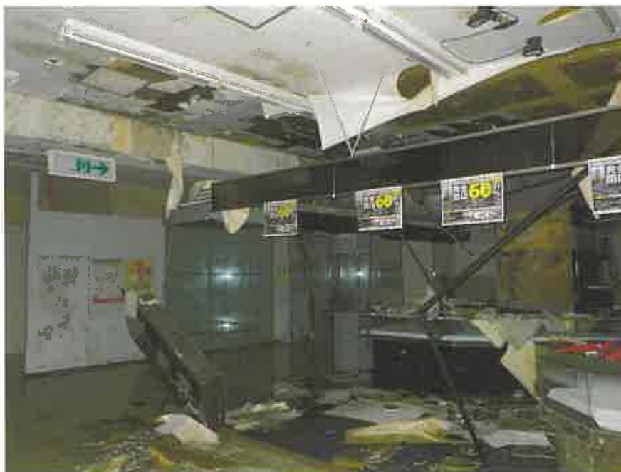
物件3の1階略南西側の元店舗部分
