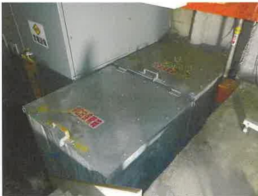
物件 7 の 6 階略南西側の電気室
