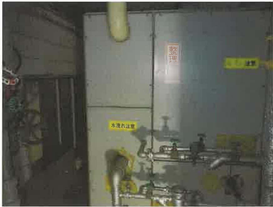
物件 3 の 3 階略南西側の空調機械室
