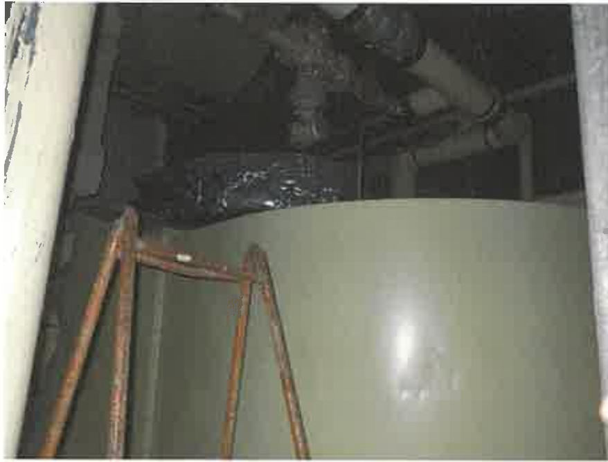
物件5の4階略西側の空調機械室
