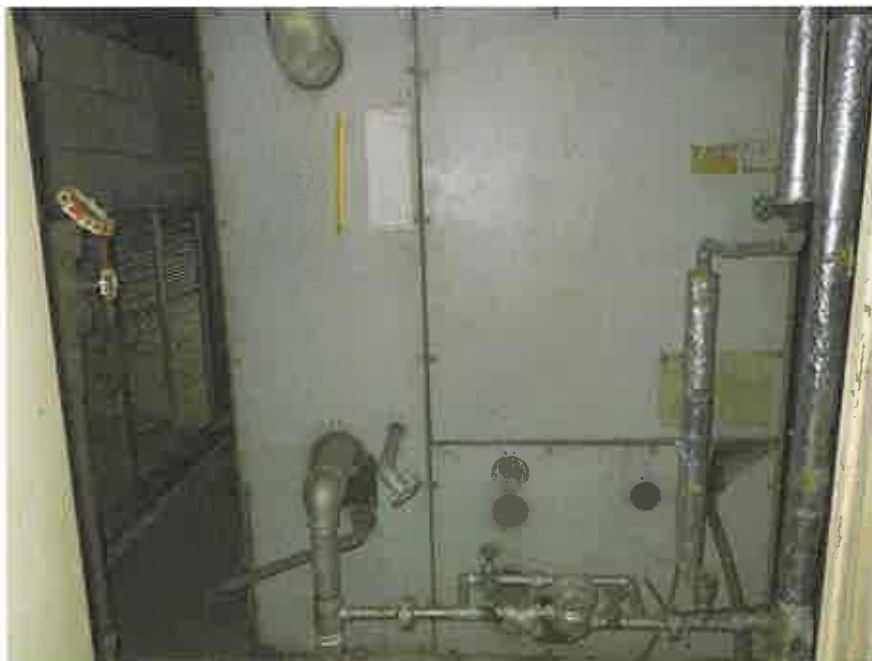
物件 3 の 1 階略南西側の空調機械室
