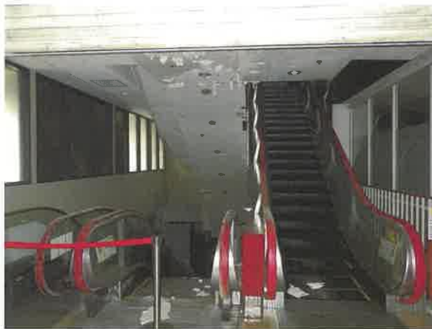
一棟の建物の1階略東側のエスカレーター
