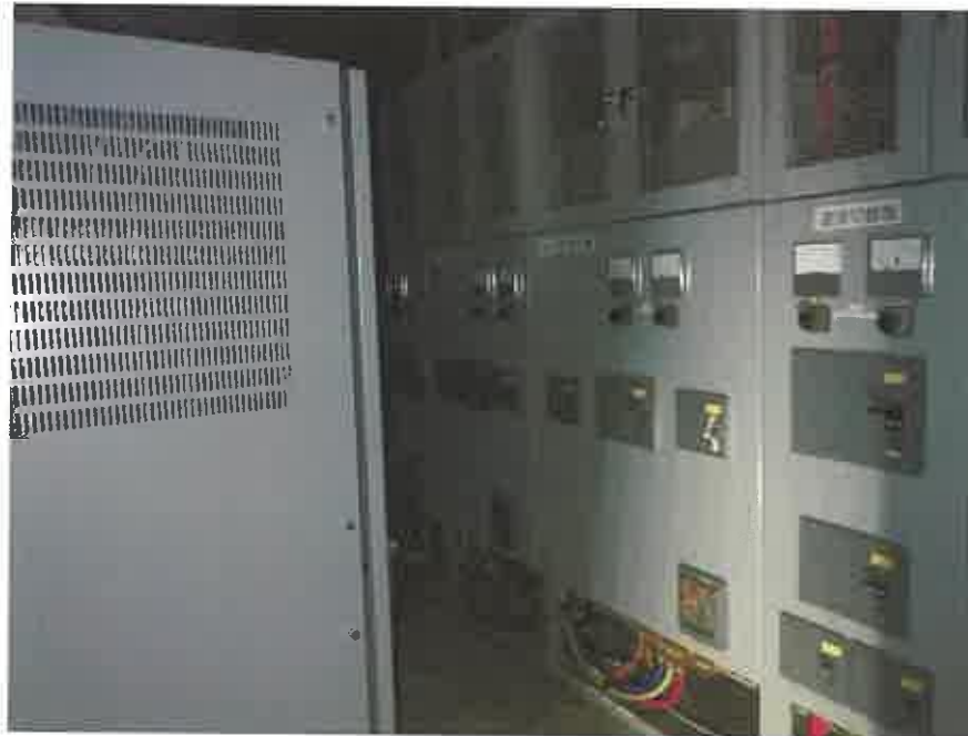
物件5の4階略南西側の電気室
