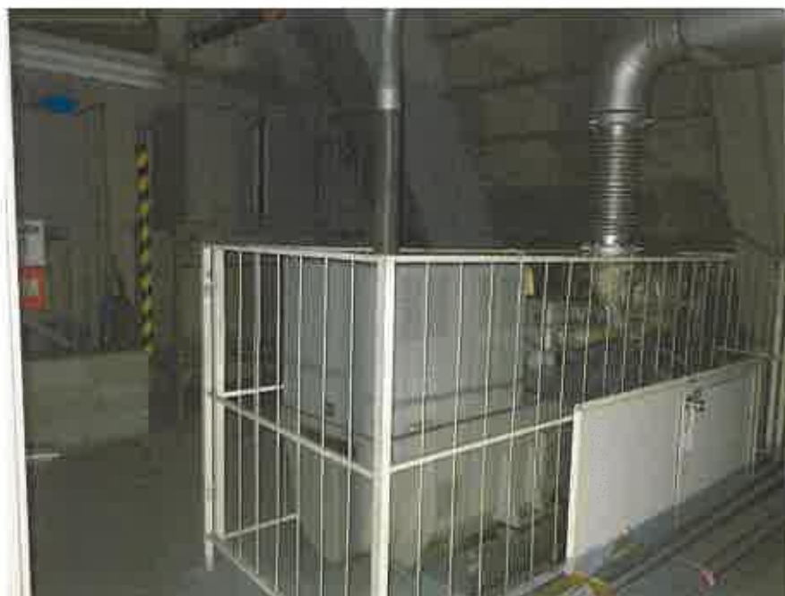
物件7の6階略南西側の発電機室
