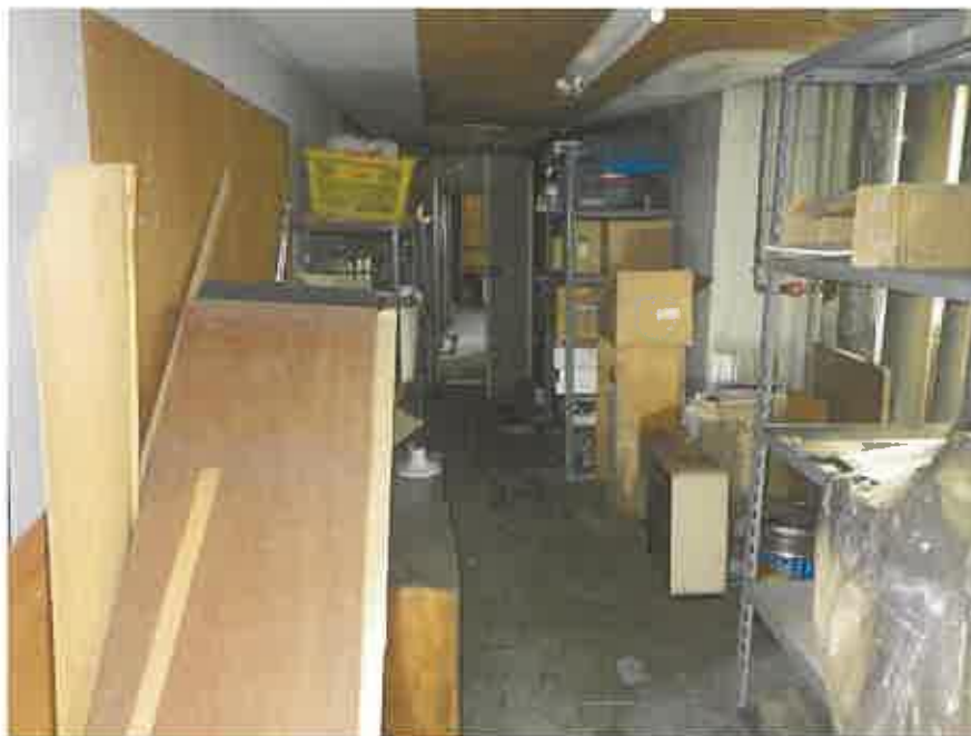
物件7の6階略西側の空調機械室
