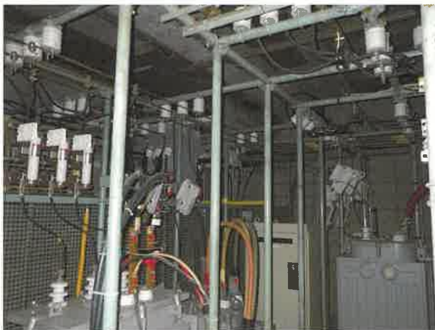
物件 3 の地下 1 階略南西側の電気室
