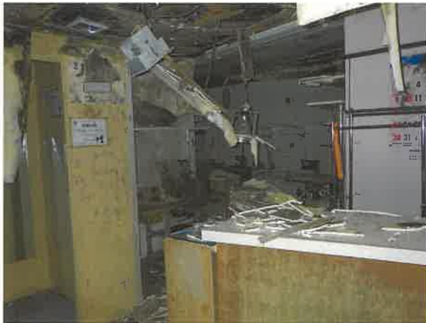
物件3の2階略南西側の元店舗部分
