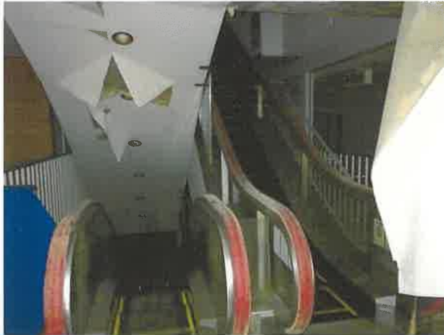
一棟の建物の3階略東側のエスカレーター
