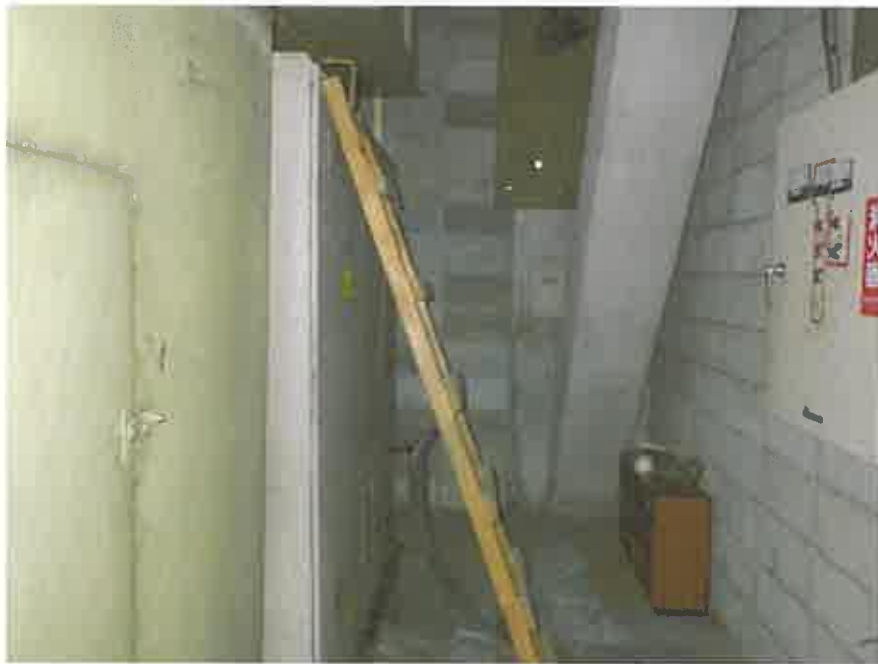
物件5の4階略西側の空調機械室
