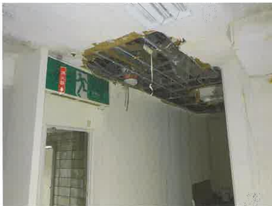
物件 7 の 6 階略南側の天井部分
