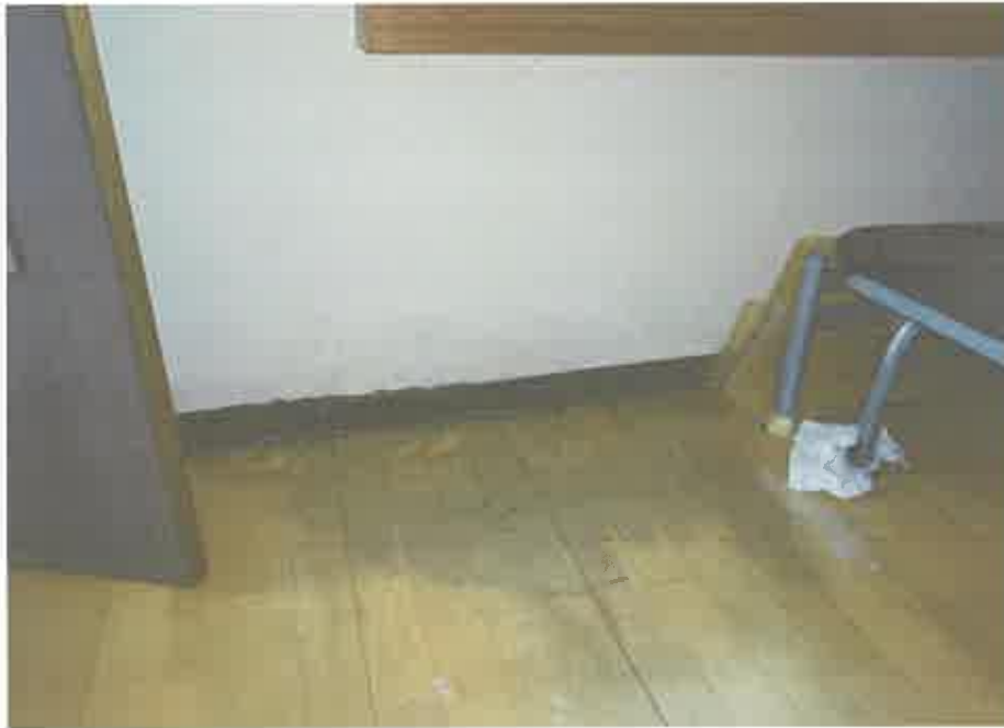
1 階洋室 1 の出窓付近の床の汚損状況
