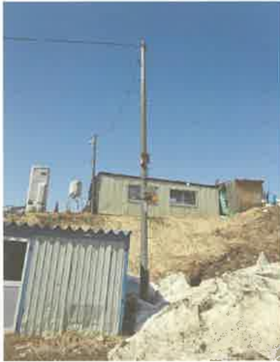
北海道電力ネットワーク株式会社所有の電柱
