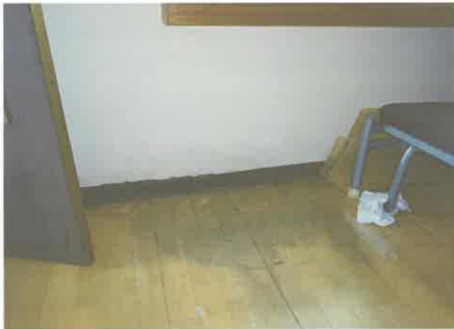
1 階洋室 1 の出窓付近の床の汚損状況
