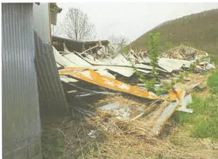
物件 1 2 建物の倒壊状況
