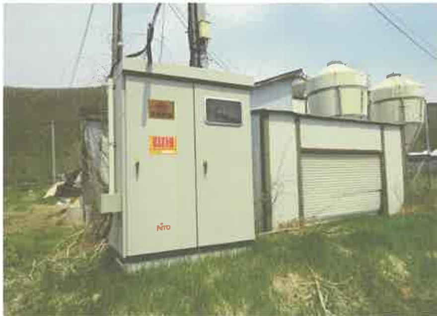
キュービクル及びスチール製仮設物置
