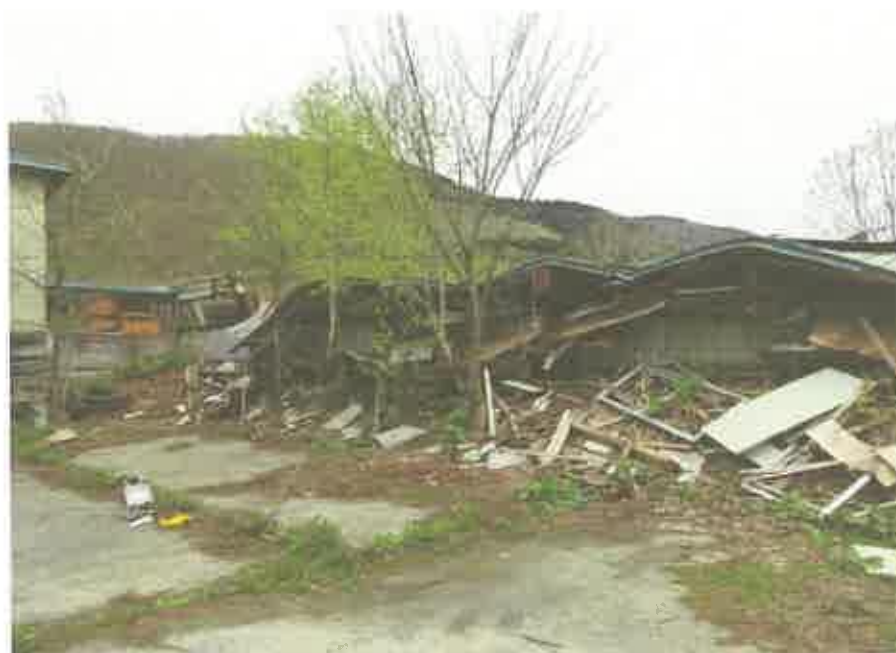
物件1 2 建物の倒壊状況
