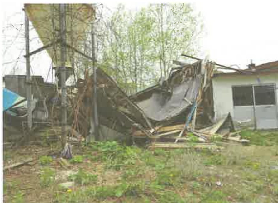
物件 1 2 建物の倒壊状況
