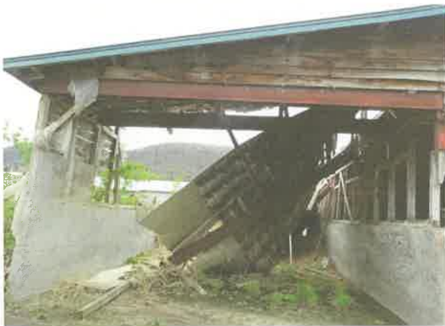
物件1 2 建物の未登記附属建物③（倉庫）の倒壊箇所の状況
