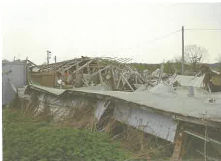
物件1 2 建物の附属建物（符号1）の倒壊状況
