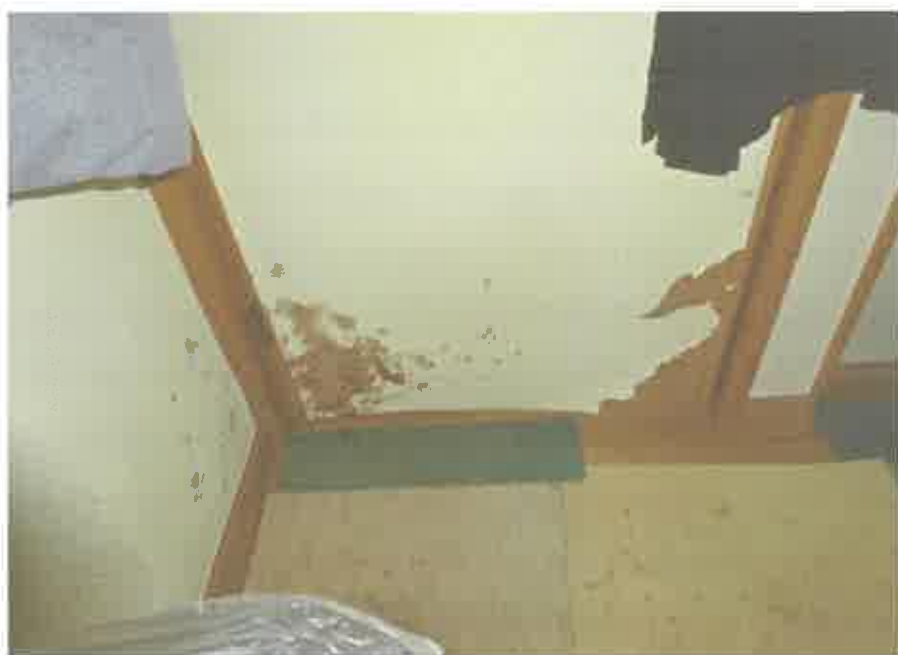
1階和室1の入口ドアのクロスの損傷等
