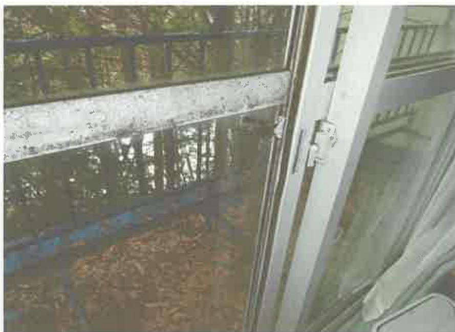
2階バルコニー（床板が存在しない）
