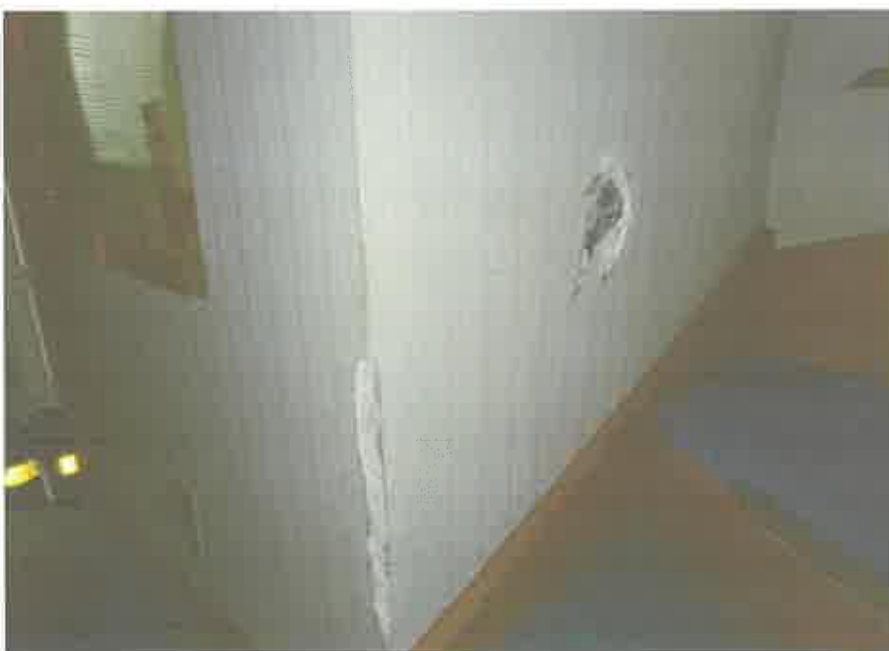
1階階段部分の損傷状況
