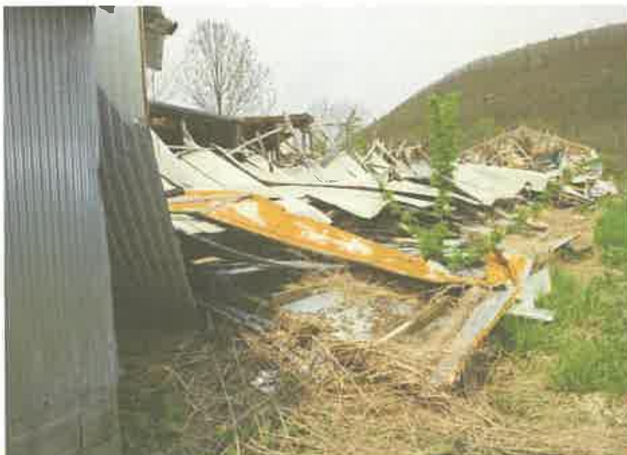
物件 1 2 建物の倒壊状況
