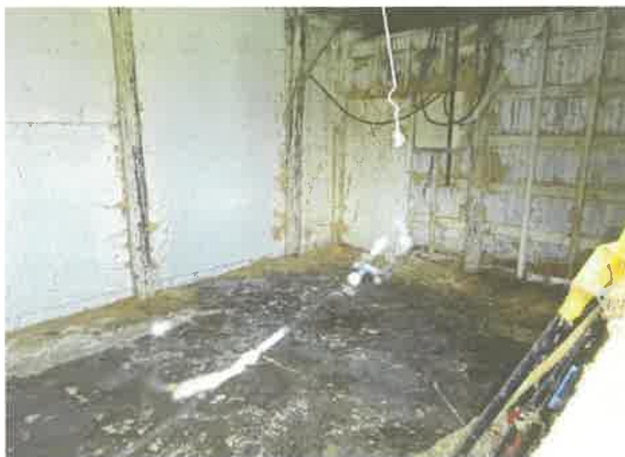
前記 2 2 写真（畜舎の残存部分）の内部の状況
