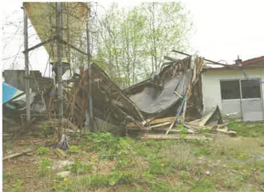
物件 1 2 建物の倒壊状況
