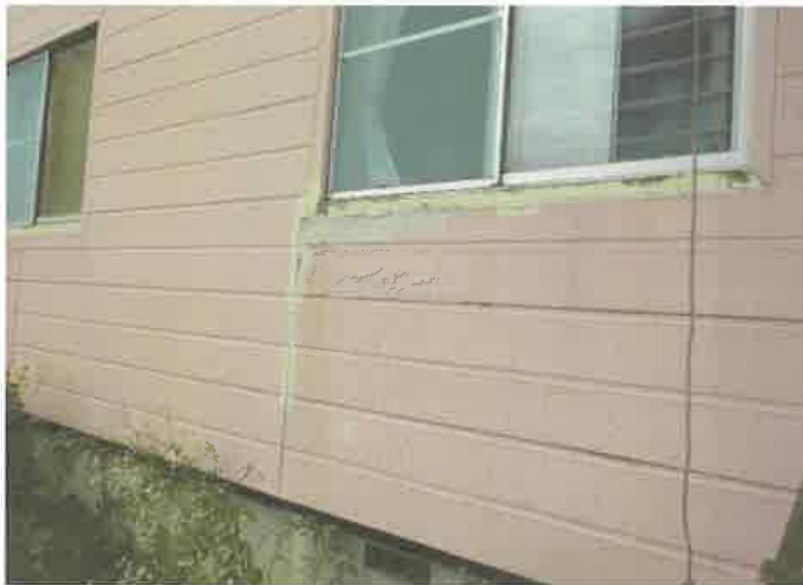
本件建物外壁の損傷状況
