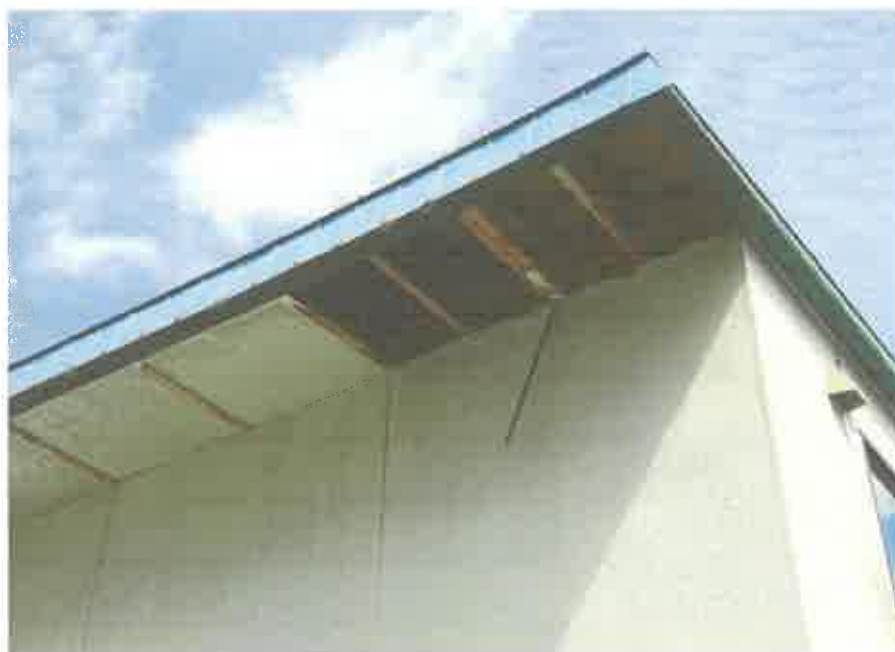
北西側軒天の損傷状況
