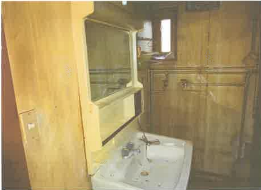
1階居宅部分の脱衣室
