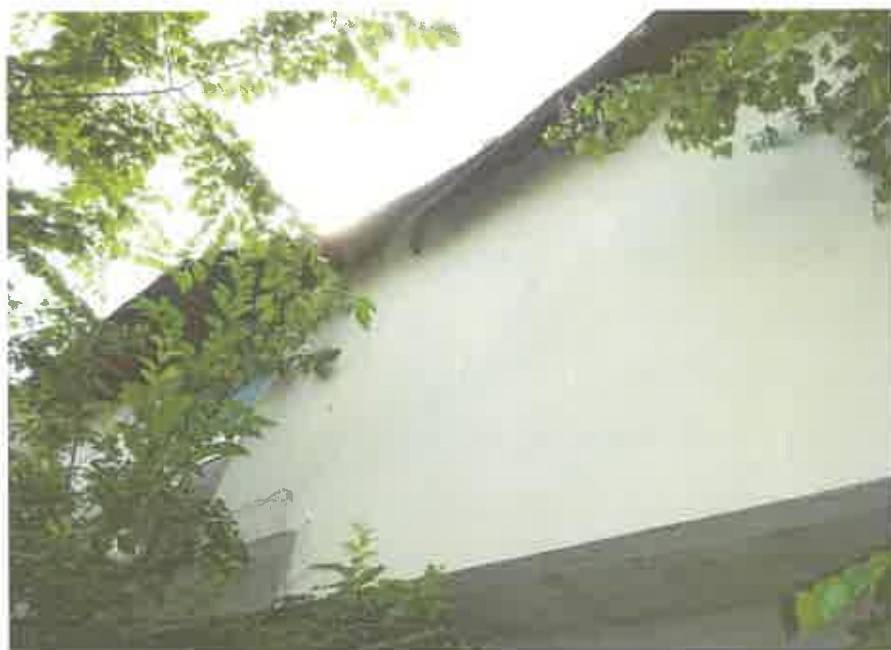
南東側軒天の損傷状況
