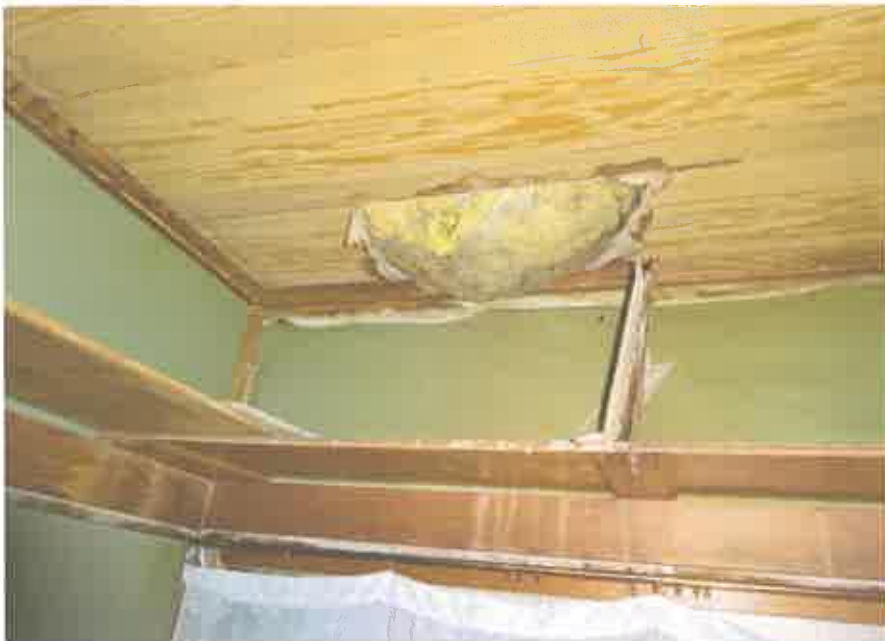
1 階居宅部分の和室 3 の天井の損傷状況
