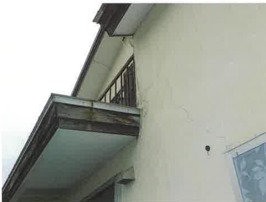
外壁等のひび割れ
