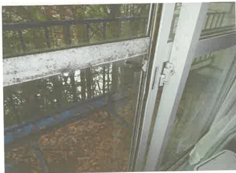
2階バルコニー（床板が存在しない）
