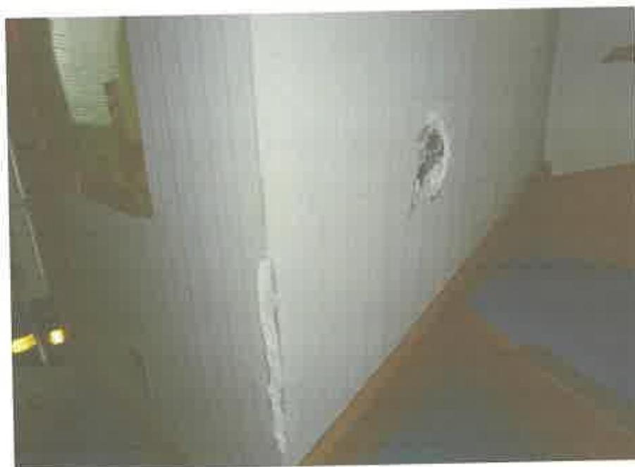
1階階段部分の損傷状況
