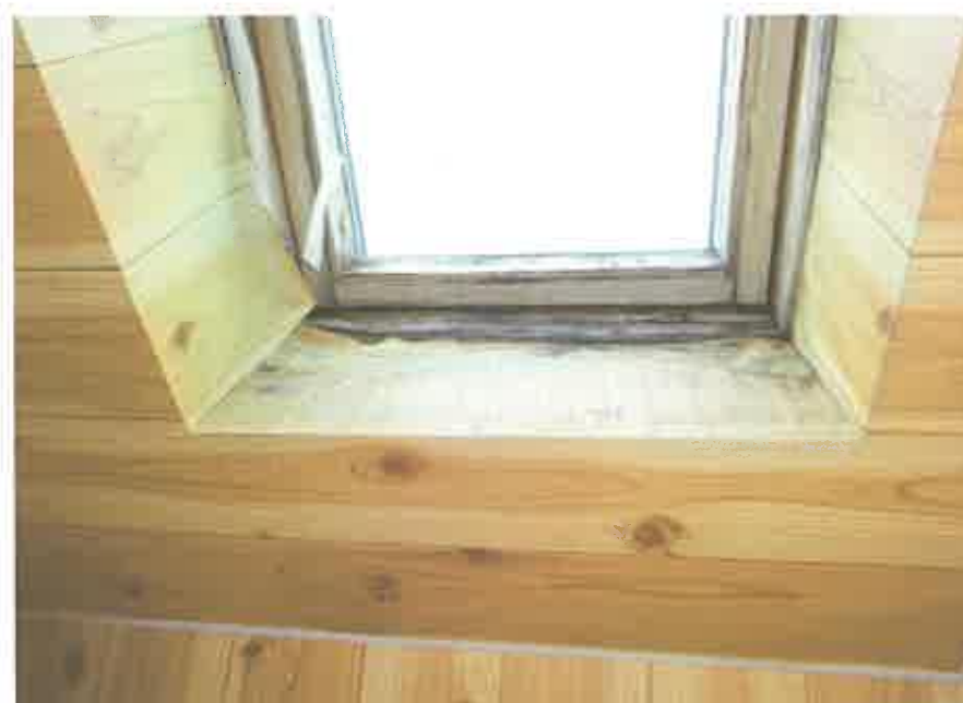
2 階洋室 1 の天窓付近の状況（壁紙の剥離等）
