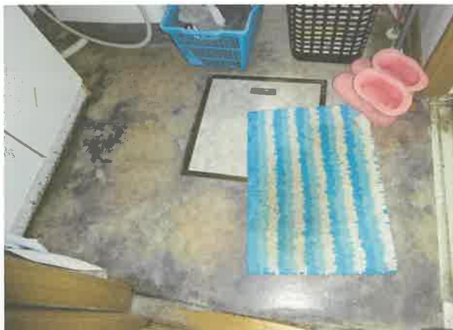
1 階洗面脱衣所の床の汚損状況
