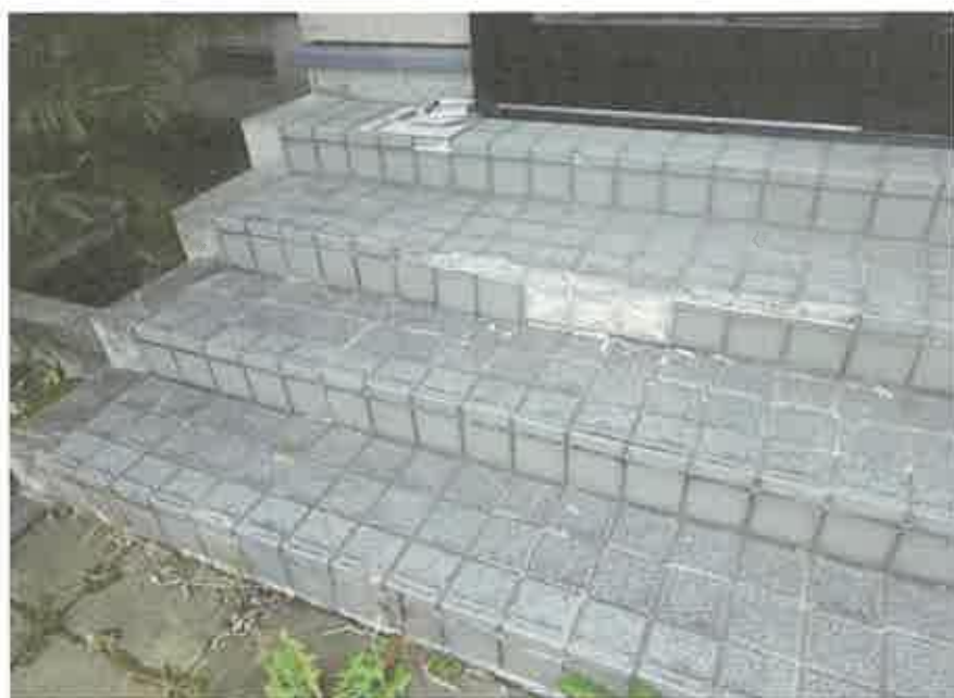
風除室前の階段のタイルの剥離状況
