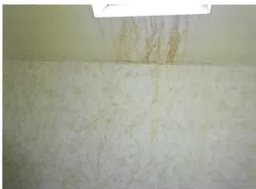
2 階洋室 2 の天窗付近の雨漏り跡の状況
