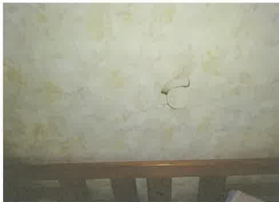
2 階洋室 2 の壁の凹みの状況
