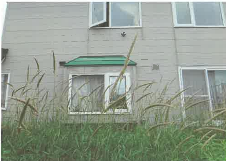
本件建物の外壁の劣化、損傷状況
