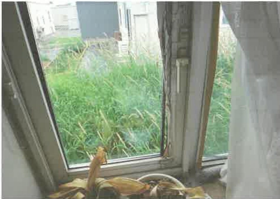
1 階台所・食堂 2 の出窓ガラスの隙間
