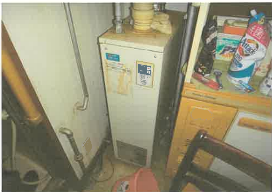
1階ユーティリティー内の石油給湯機付ふろがま
