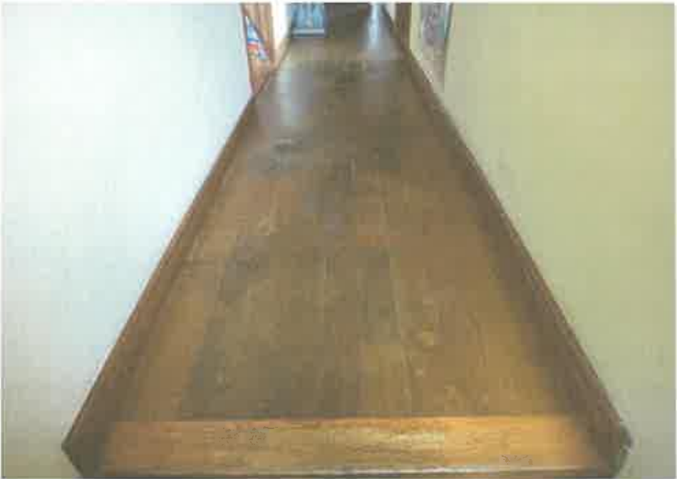
2 階廊下の劣化
