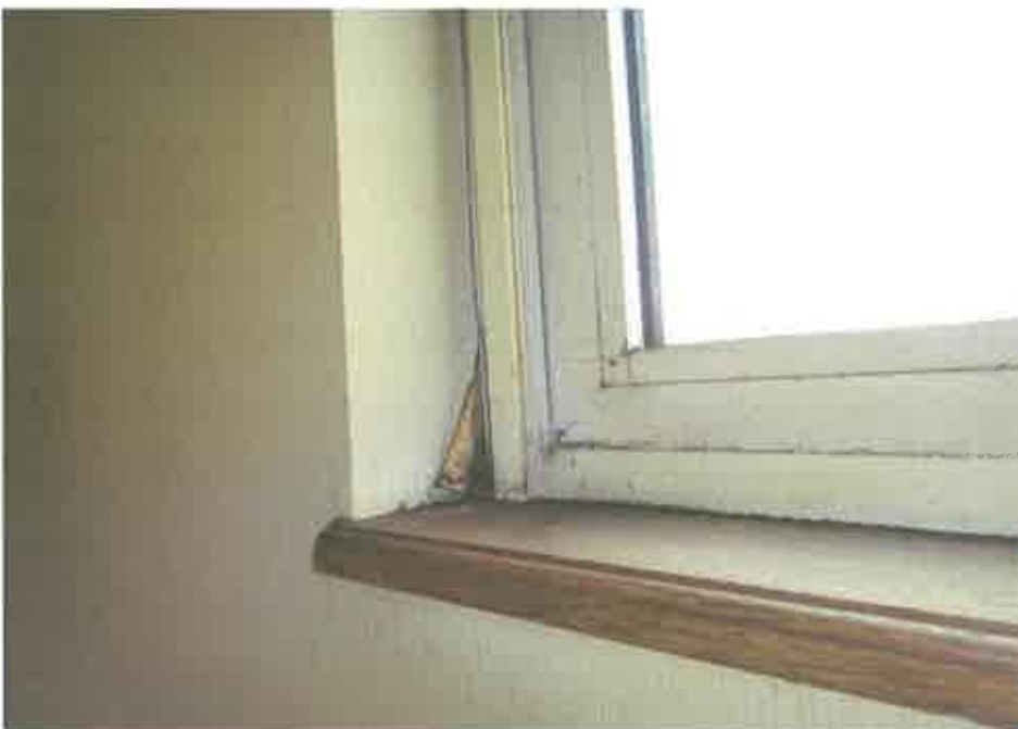
階段付近の窓枠の汚損及び壁紙の剥離
