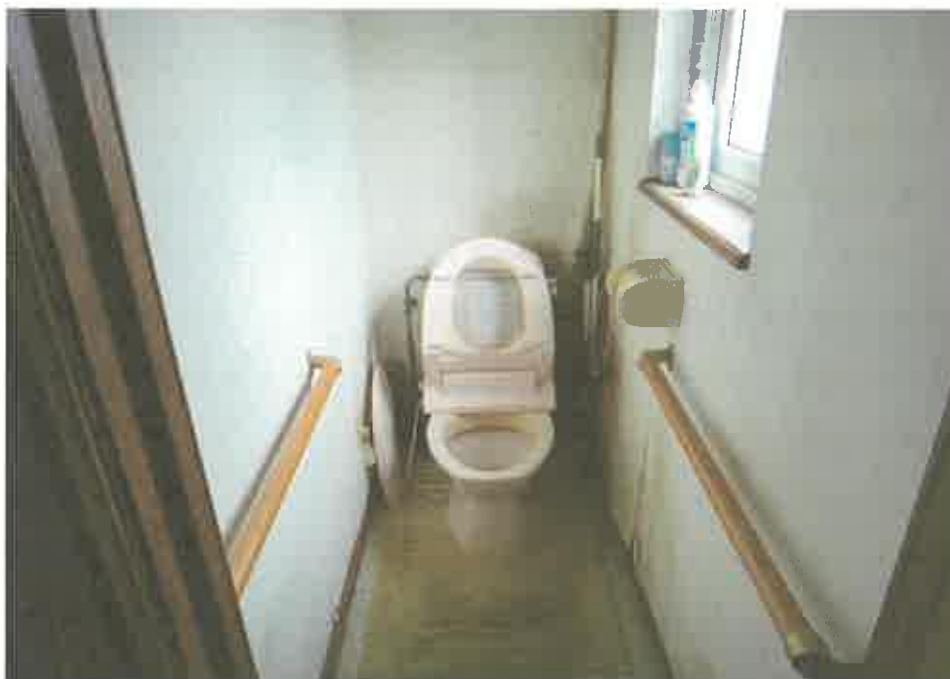
1階トイレの壁紙の汚損
