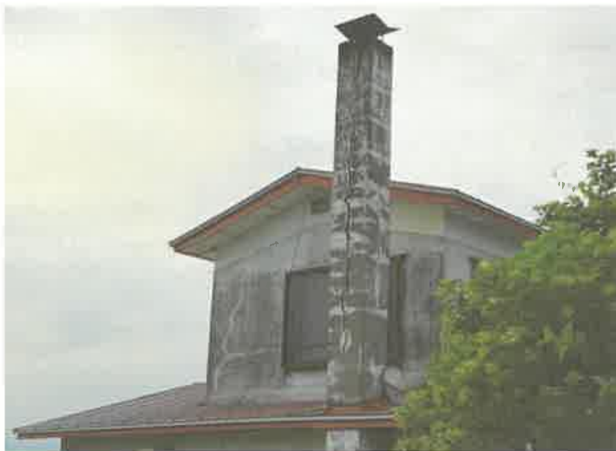
煙突の亀裂の状況
