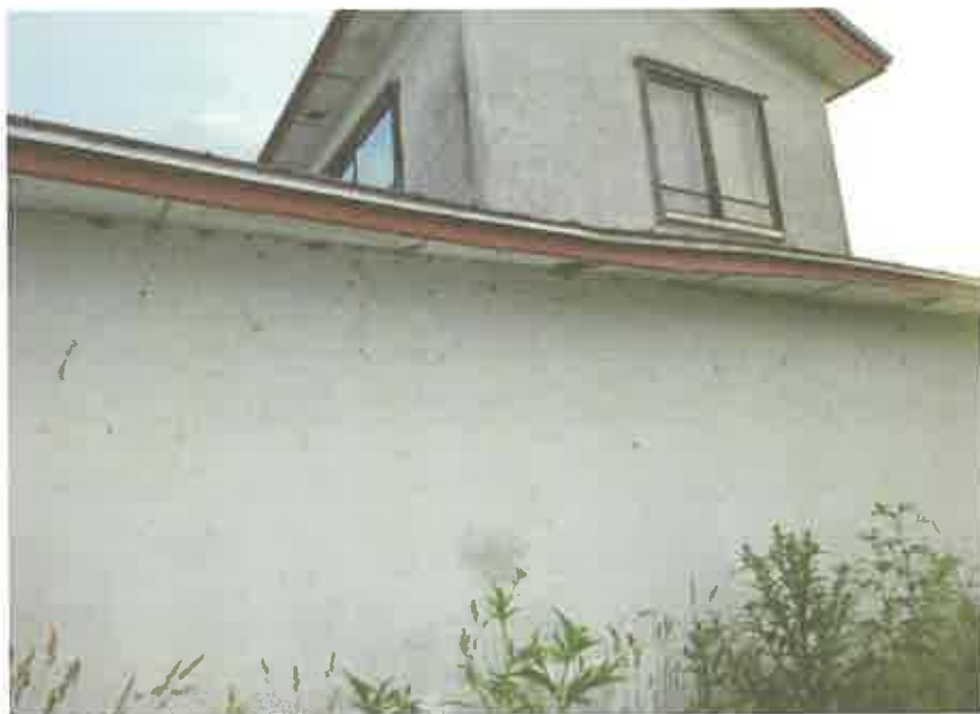
1 階の軒天の損傷状況
