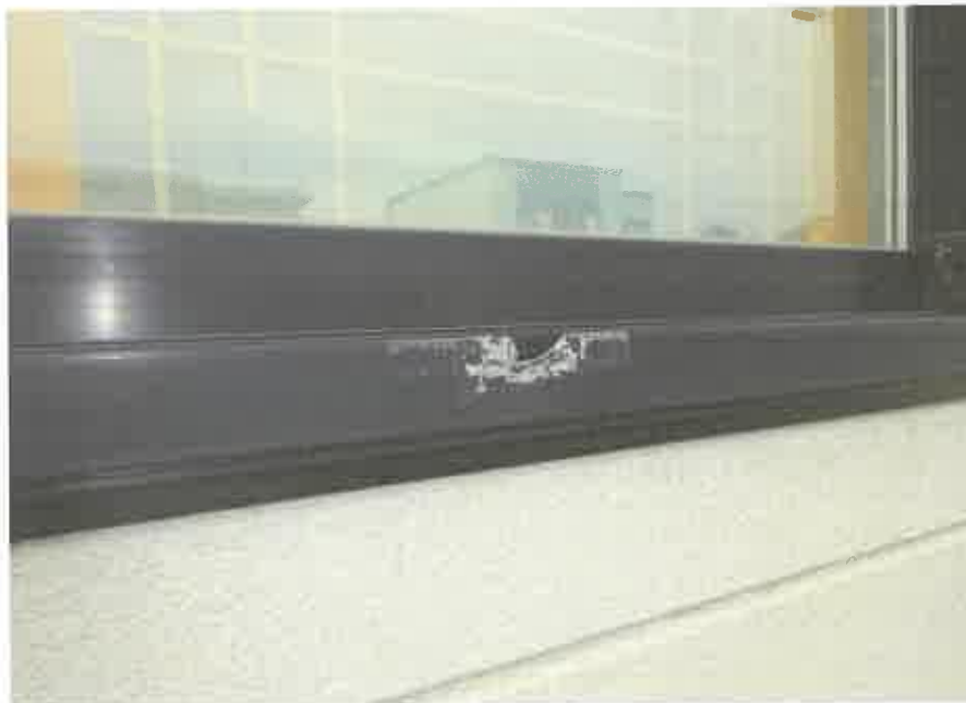
1 階和室の窓枠のレールの破損状況
