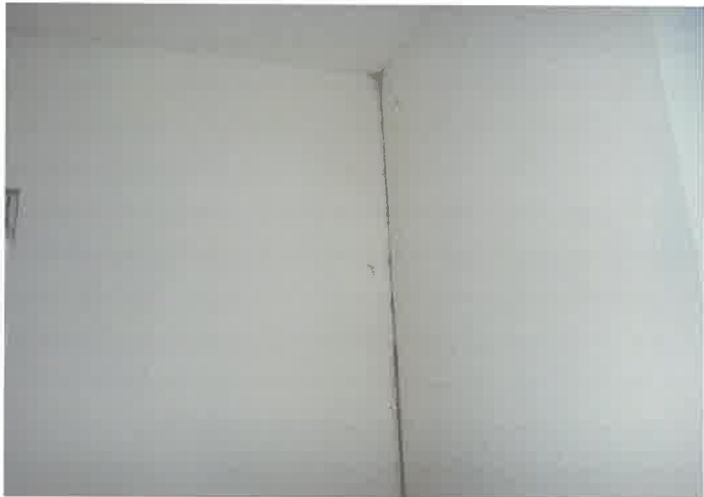
2階洋室3の壁クロスの黒ずみ
