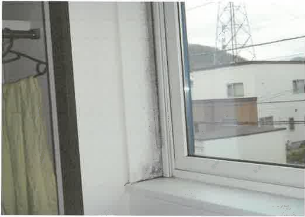
2階洋室3の窓枠の黒ずみ
