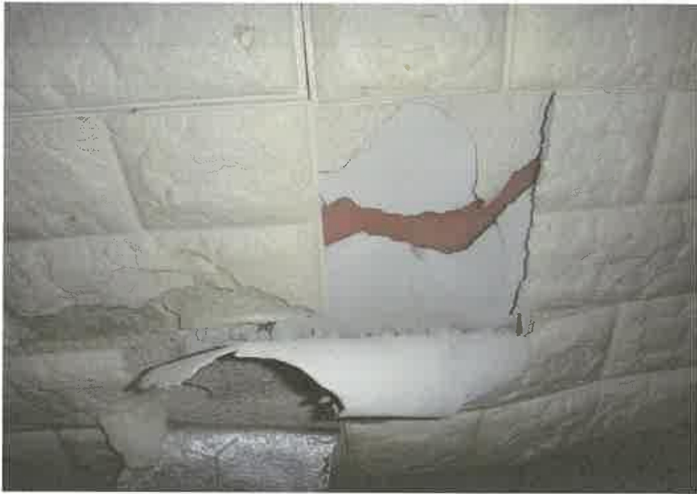
1階居間の壁クロスの損傷
