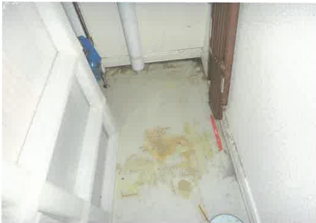
1階ユーティリティー内の床の汚損
