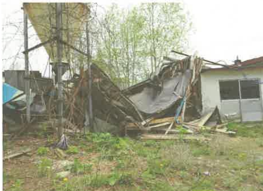
物件 1 2 建物の倒壊状況
