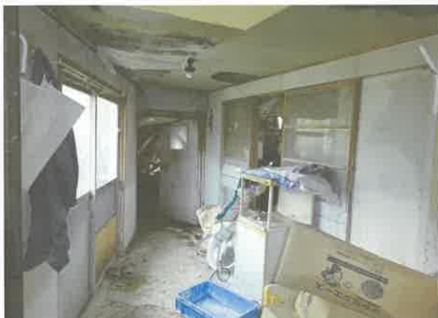
物件1 2 建物のうち、居宅部分から畜舎に繋がる前室の部分 (前方ドアの向こう側の畜舎は倒壊している。)
