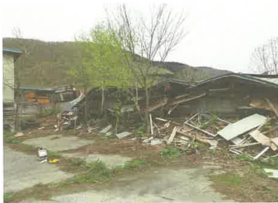
物件1 2 建物の倒壊状況
