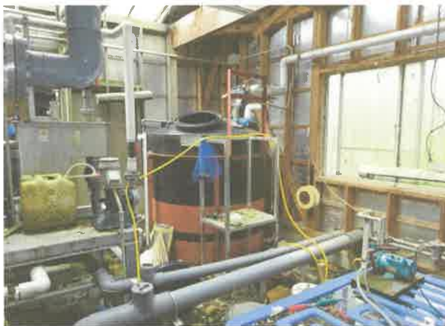
物件13建物（機械室）内部の状況
