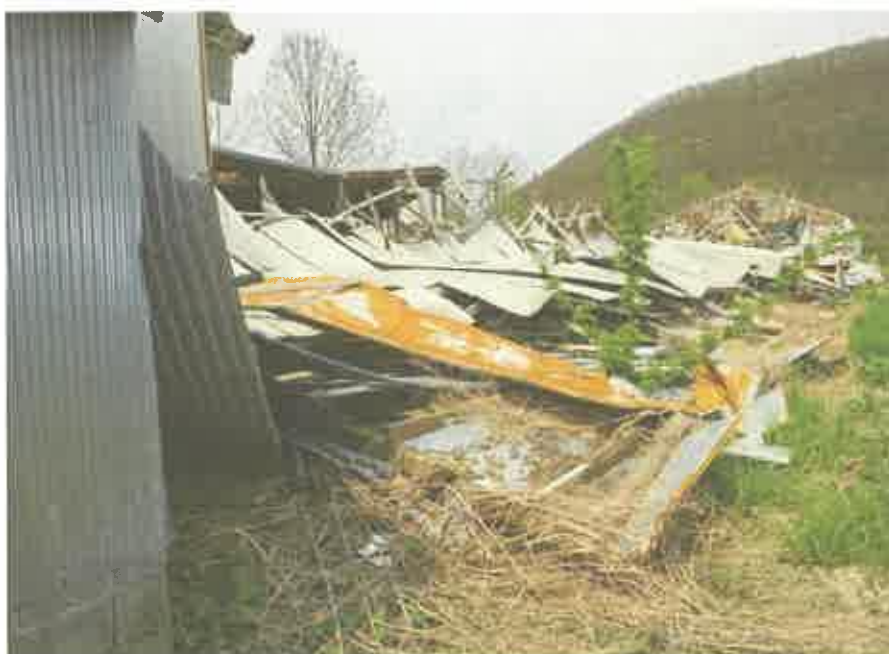
物件 1 2 建物の倒壊状況
