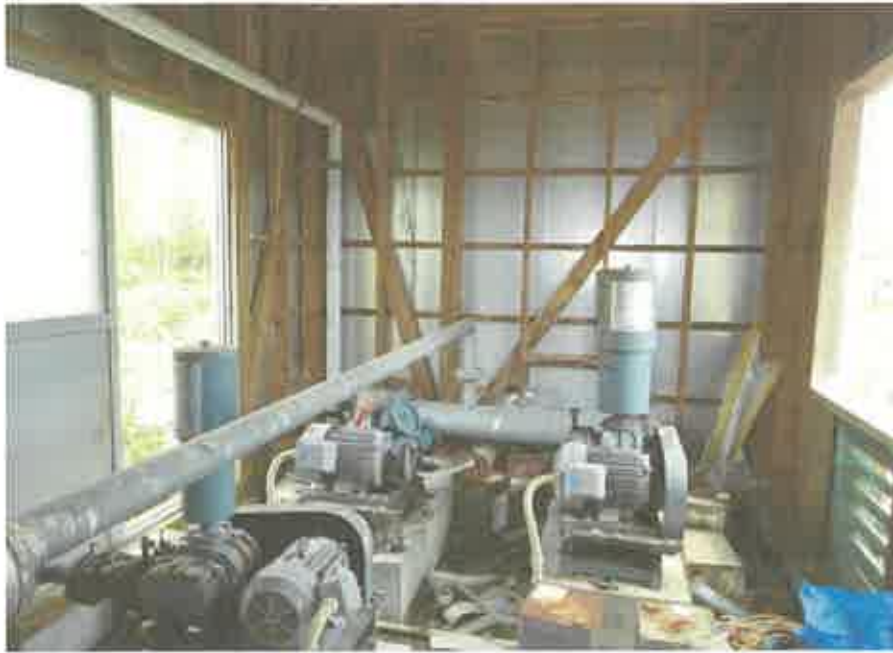
物件1 3 建物（機械室）内部の状況
