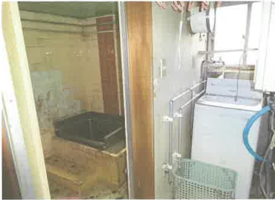
物件1 2 建物のうち、居宅部分の脱衣所、浴室
