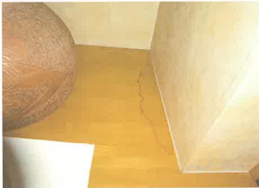
2 階廊下の棚（天窓の下）付近の汚損状況
