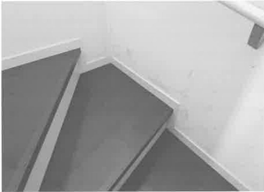
階段付近の壁紙の汚損状況
