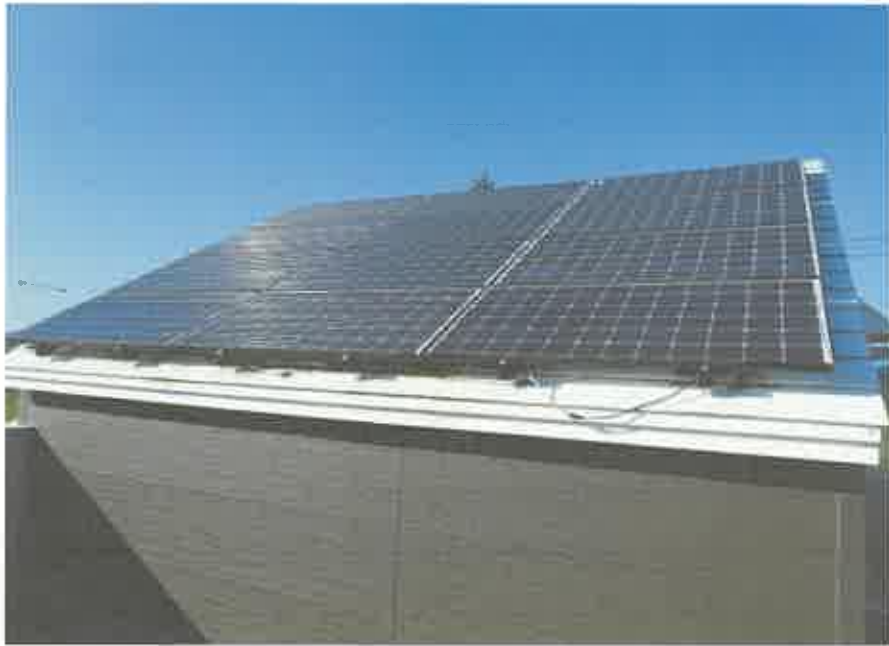
太陽光パネル
