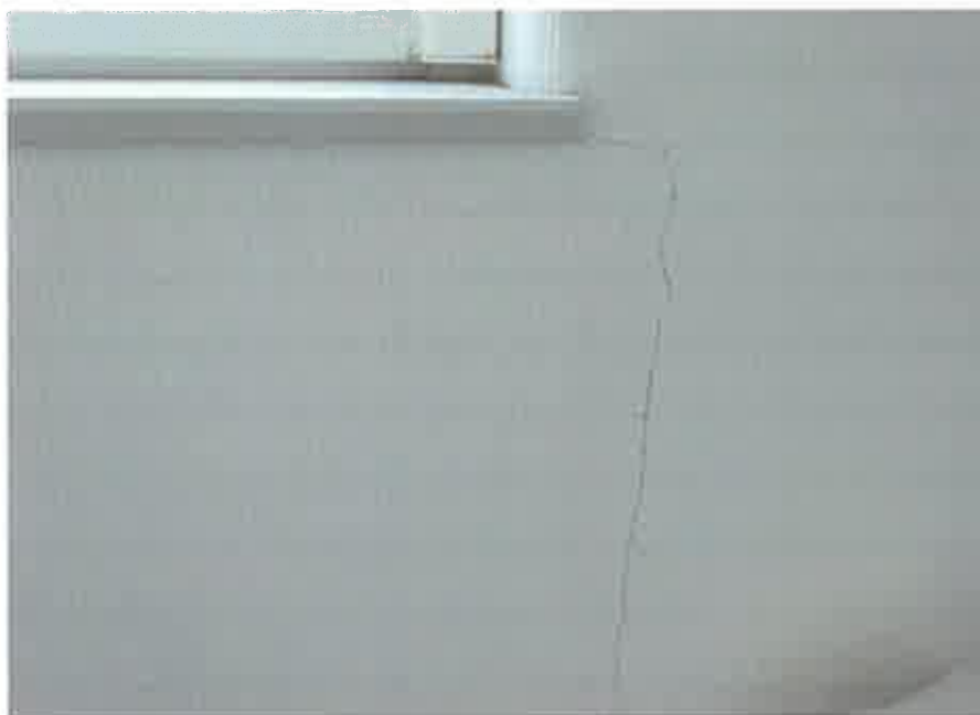
2 階洋室 3 の壁紙の亀裂の状況
