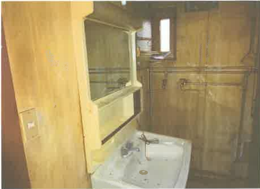
1階居宅部分の脱衣室
