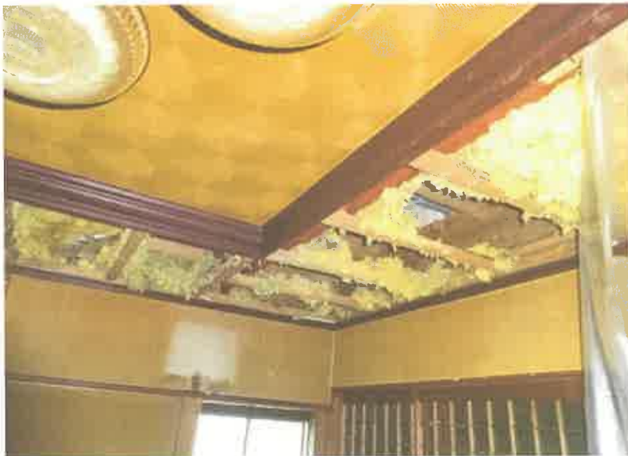
1 階居宅部分の居間の天井の損傷状況
