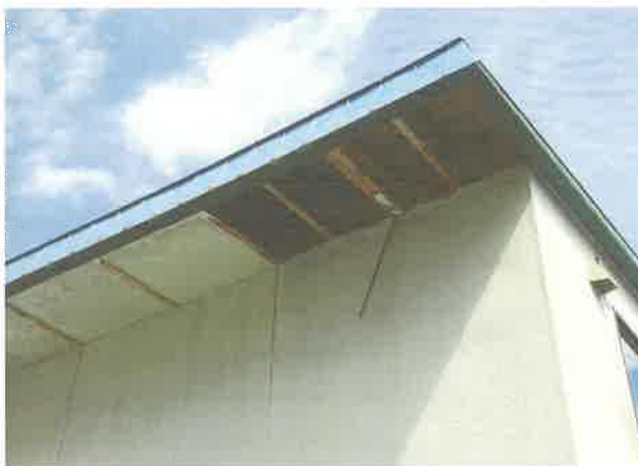
北西側軒天の損傷状況
