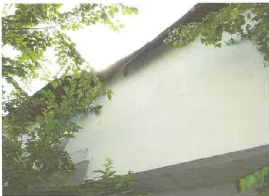
南東側軒天の損傷状況
