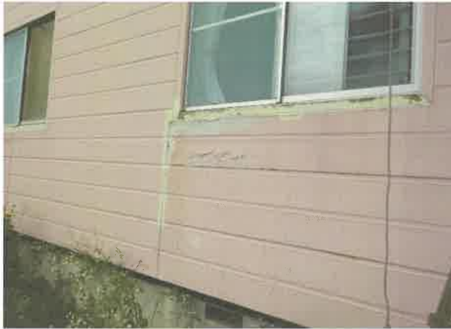
本件建物外壁の損傷状況
