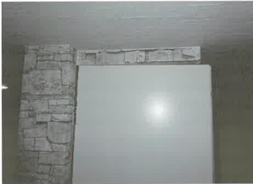
台所上部の収納スペースが壁から剥離して傾いている状況（G号室）
