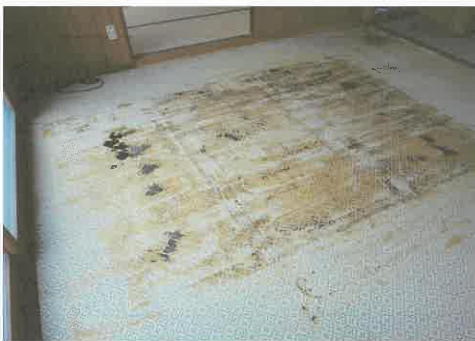
1階居間の床の汚損
