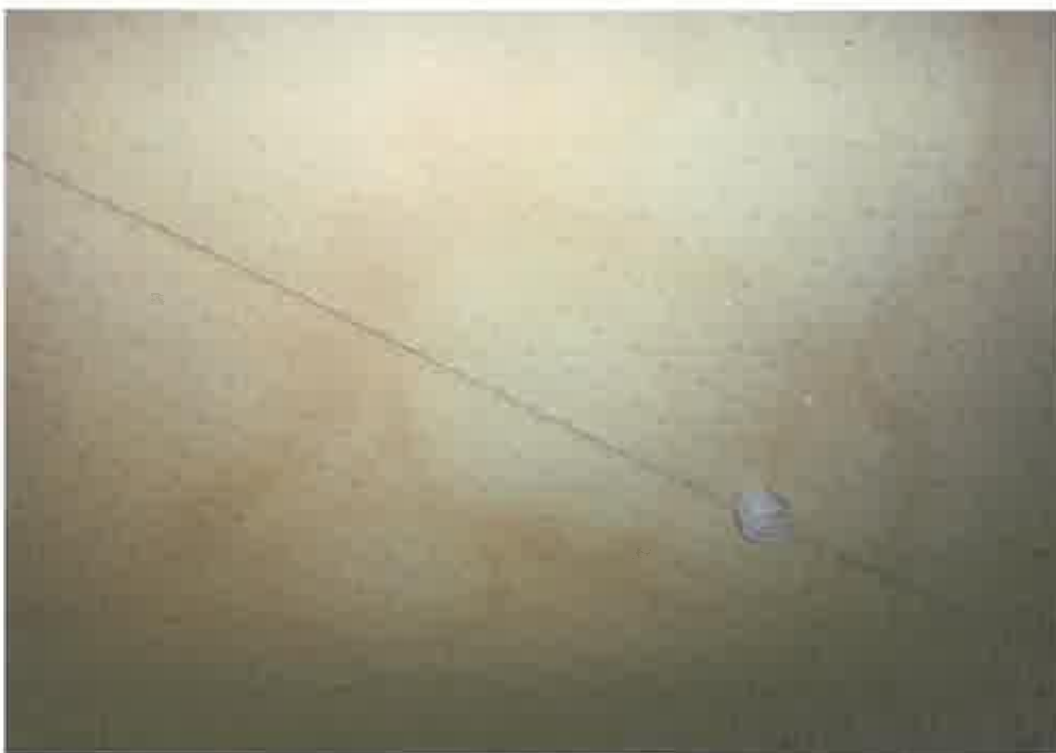
2階物置1の天井の雨漏り跡
