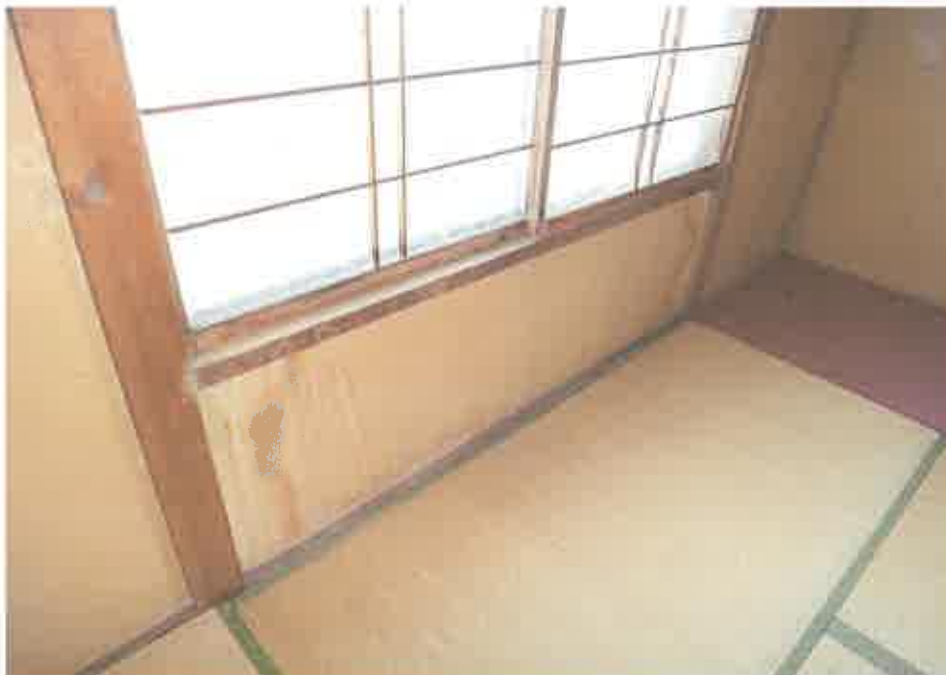
2号室2階和室2の壁面の雨漏り跡
