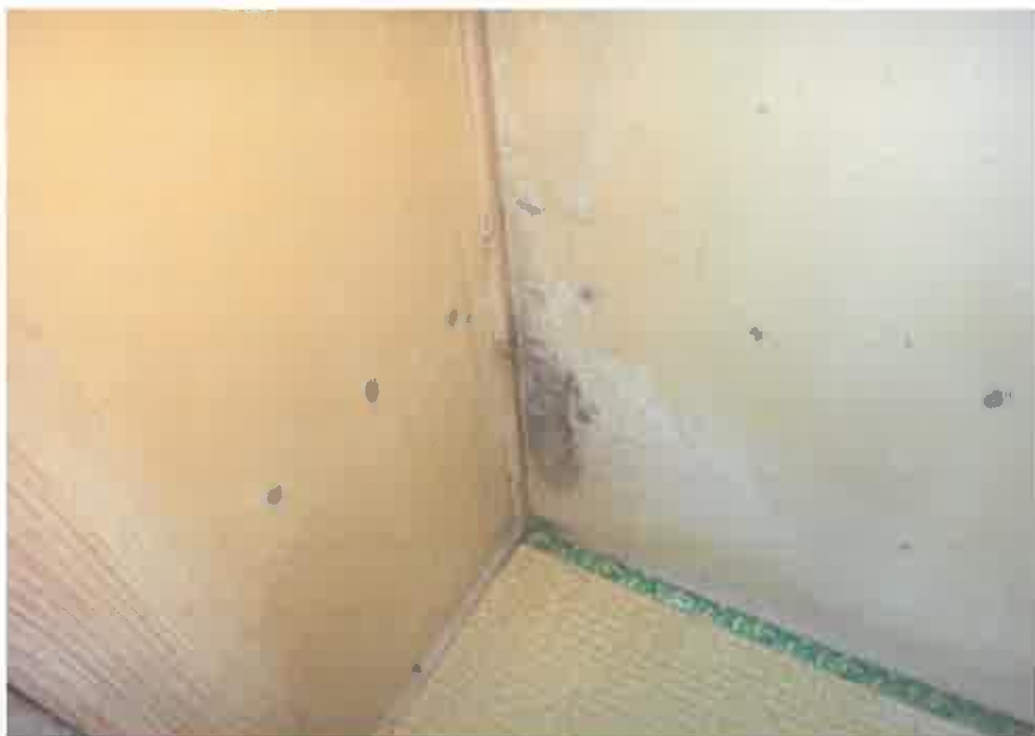
1階和室2の壁の汚損
