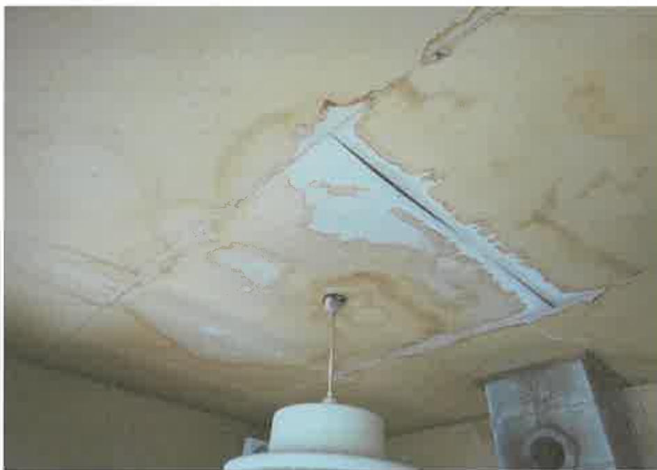
2階洋室2の天井の雨漏り跡
