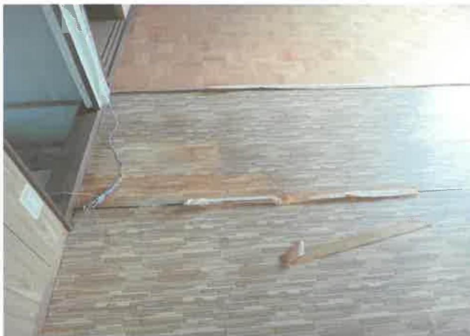
2号室1階居間の床の損傷
