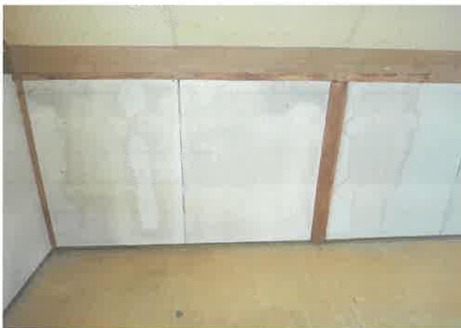
1号室2階和室1の壁面の雨漏り跡
