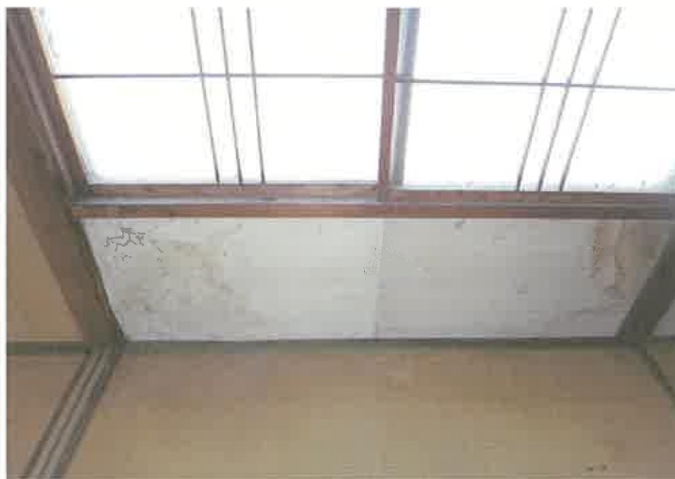
同上及び汚損
