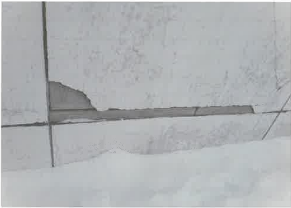
物件6の建物外壁の損傷
