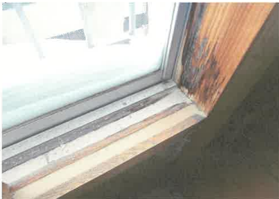
1階和室1の窓枠付近の劣化
