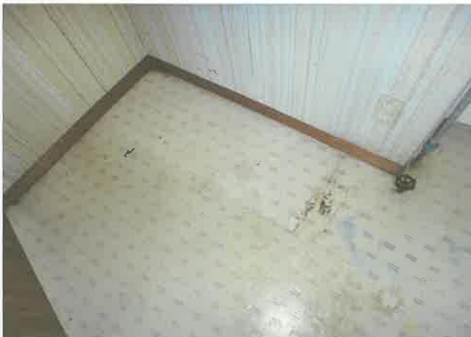
1階台所付近の床の汚損
