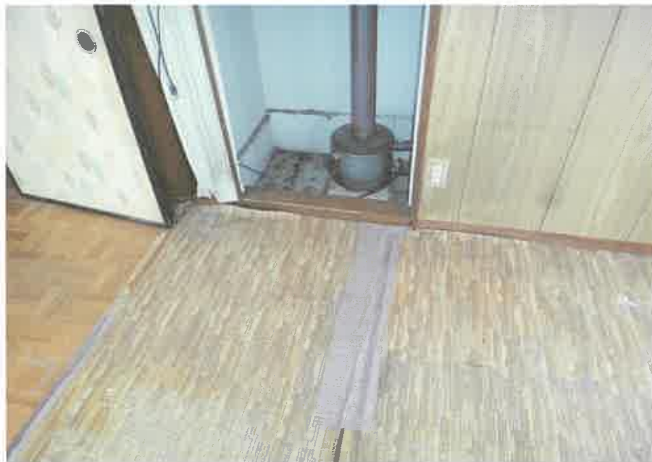
1号室1階居間の床の損傷
