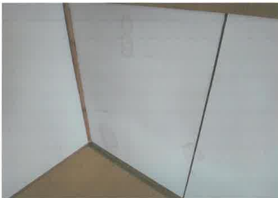
2号室2階和室1の壁面の雨漏り跡
