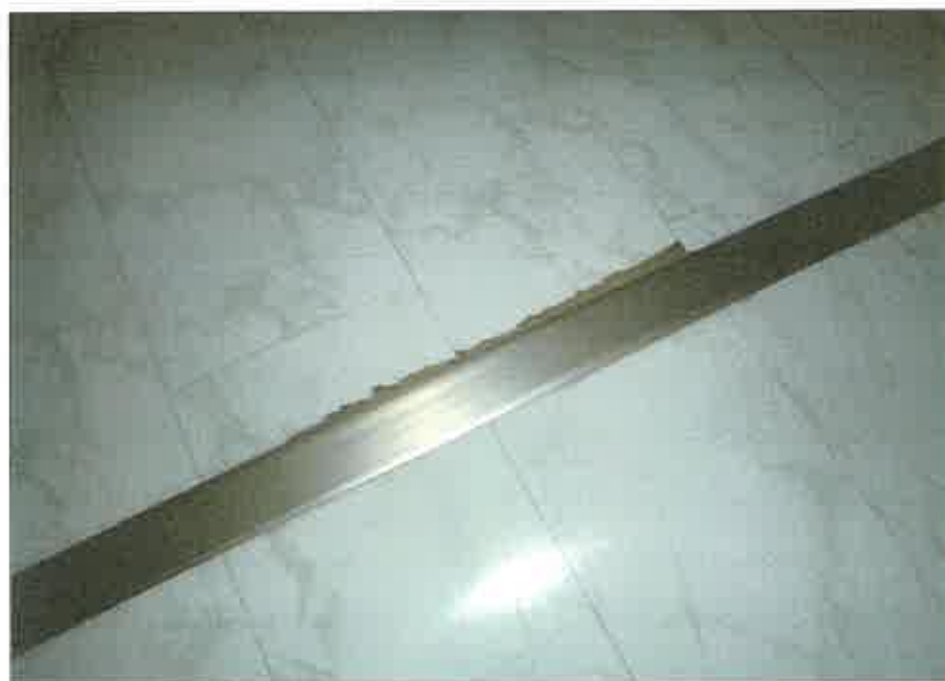
1階廊下の103号室前付近の床の一部損傷
