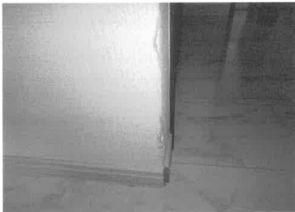
1階108号室の壁クロスの一部損傷
