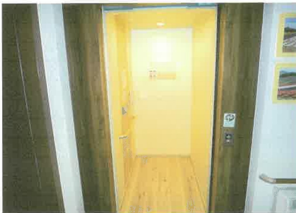
エレベーター
