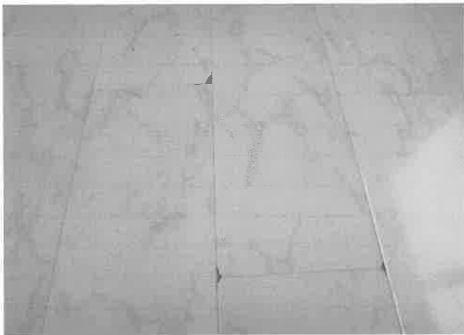
1階107号室の床の一部損傷
