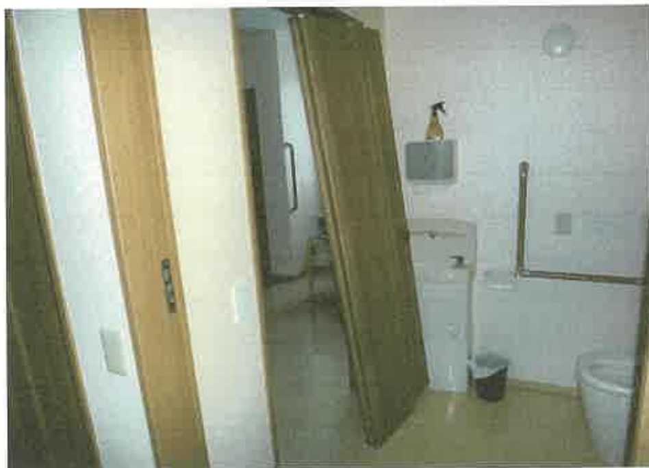
2階エレベーター横の脱衣室と隣接するトイレの間にある扉の損傷
