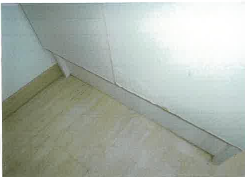
2階213号室の洗面台下部の収納扉の損傷
