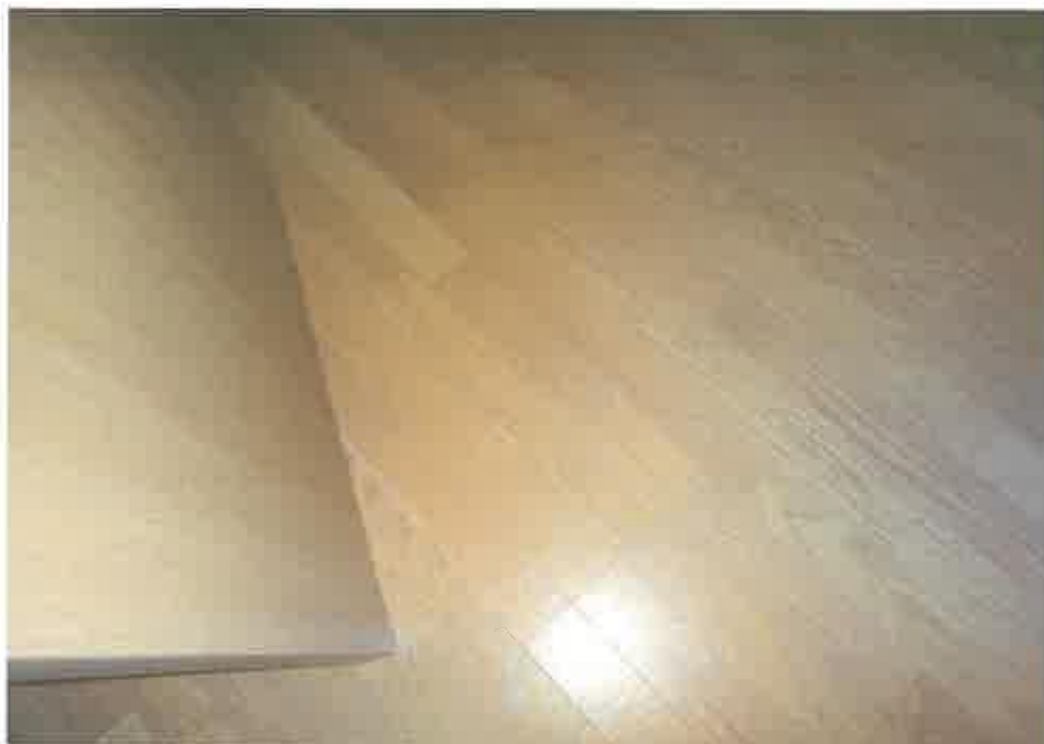
2階洋室5のドアによる床の擦り傷
