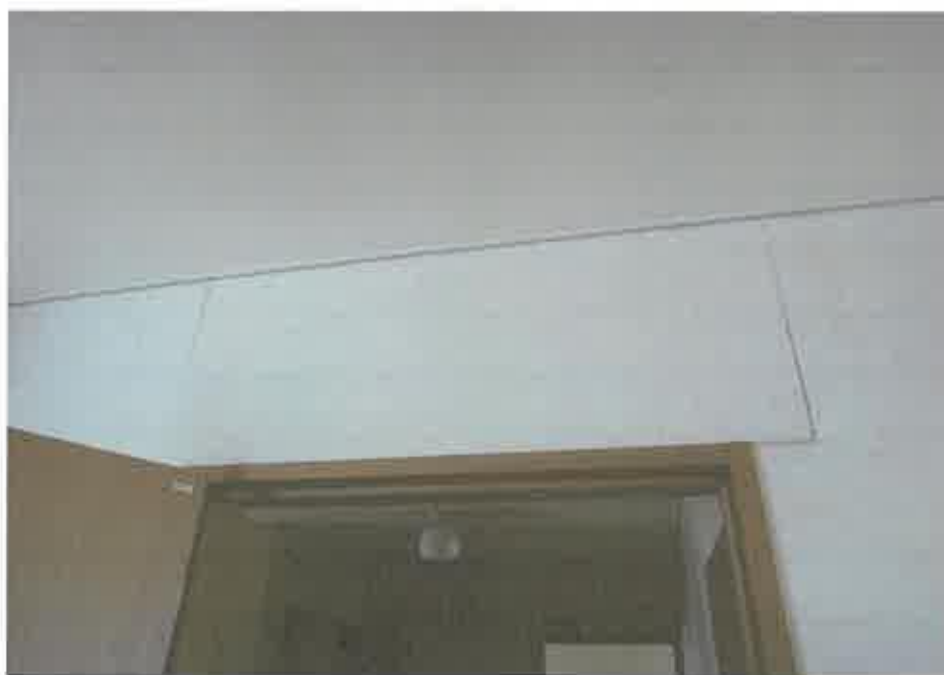
2階洋室3のドア上部の壁クロスの亀裂
