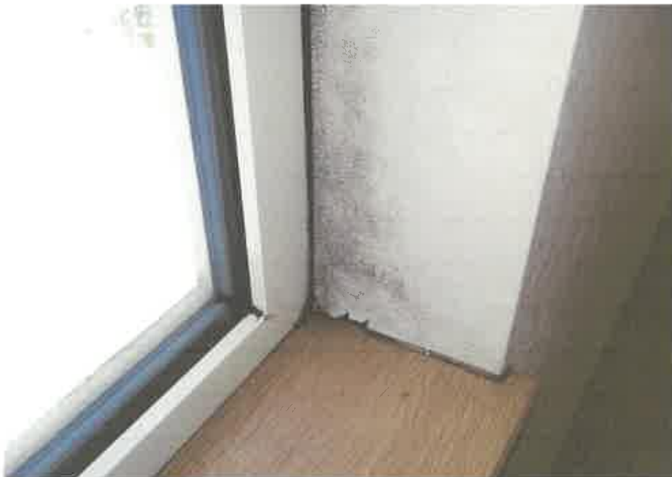
2階洋室5の窓付近の壁クロスの汚損及び剥離
