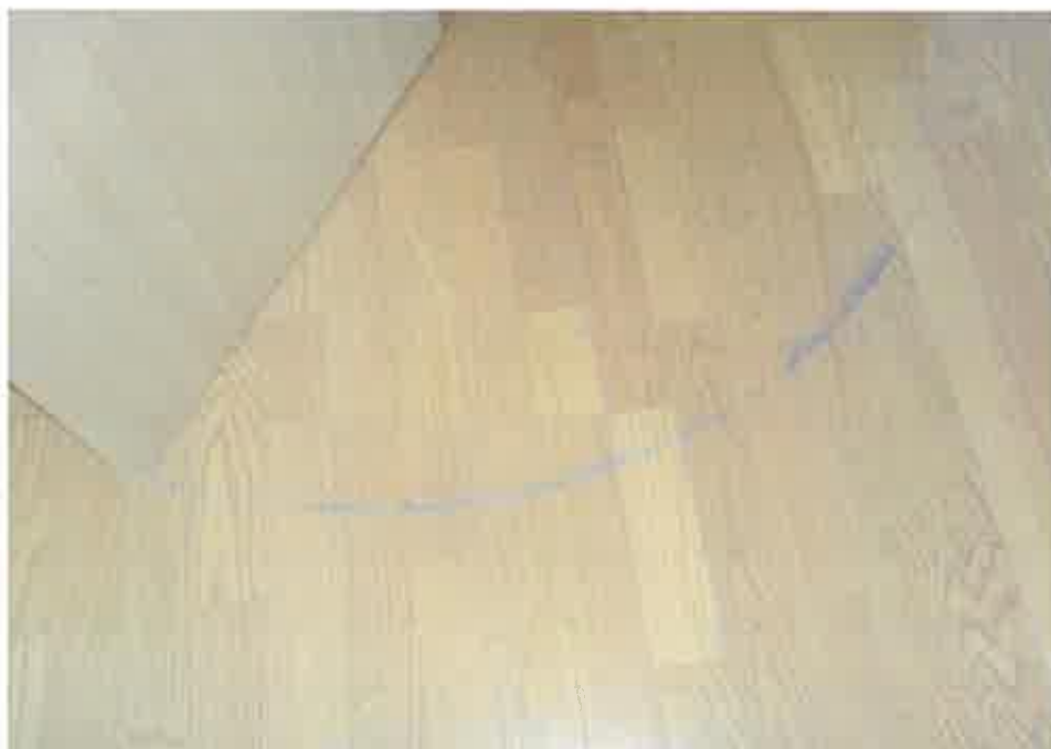
2階洋室3のドアによる床の擦り傷
