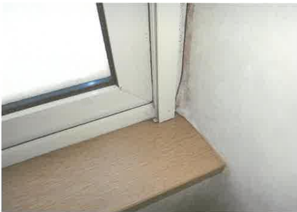
階段の窓付近の壁クロスの汚損及び剥離
