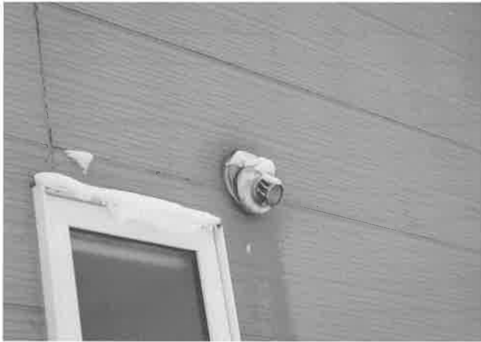
通気口カバーの破損
