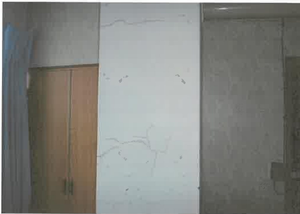
2階洋室3内の煙突の壁面部分のひび割れ
