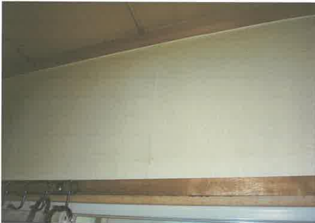
1階和室1の壁面のひび割れ
