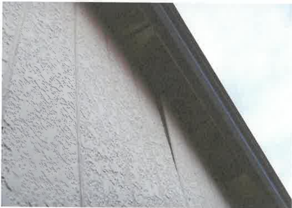
未登記附属建物（車庫）の外壁の損傷
