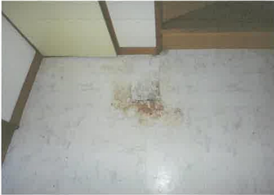
2階台所付近の床の汚損
