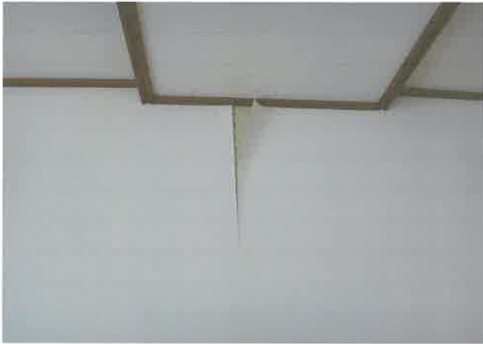
3階洋室3の壁クロス剥離
