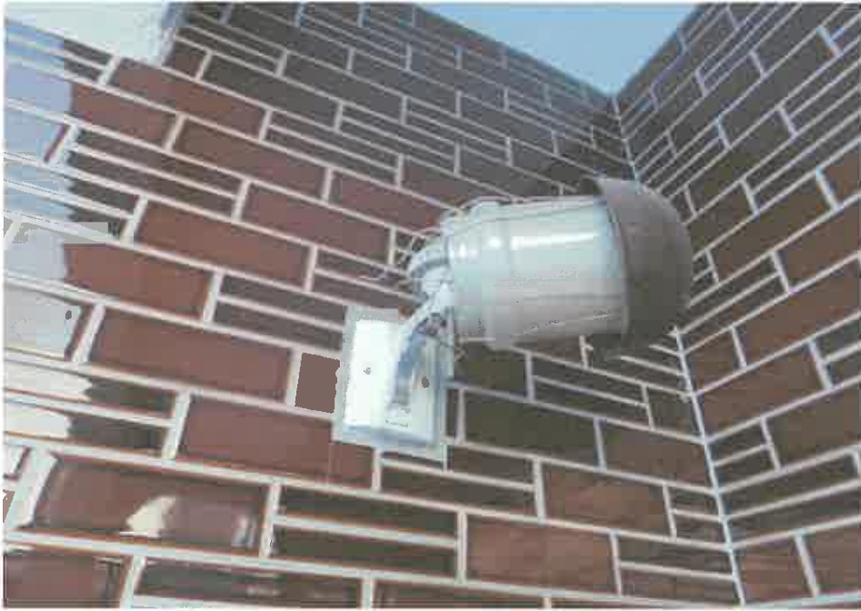
玄関灯の損傷
