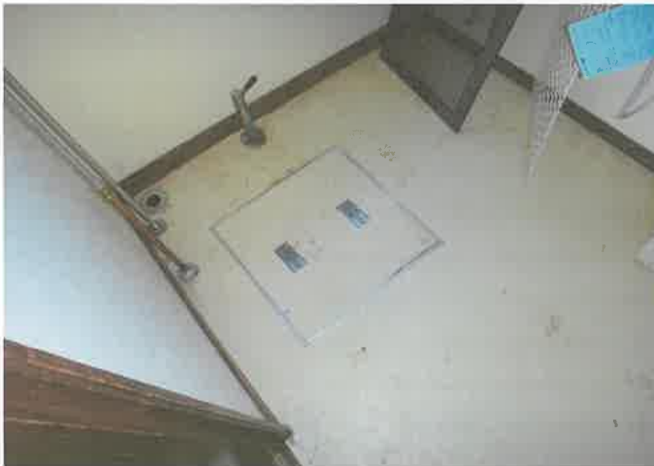
2階ユーティリティ内の床の汚損
