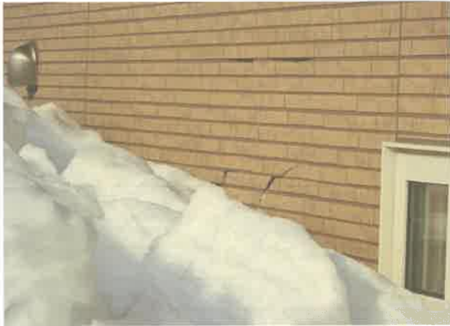
本件建物の外壁の損傷状況
